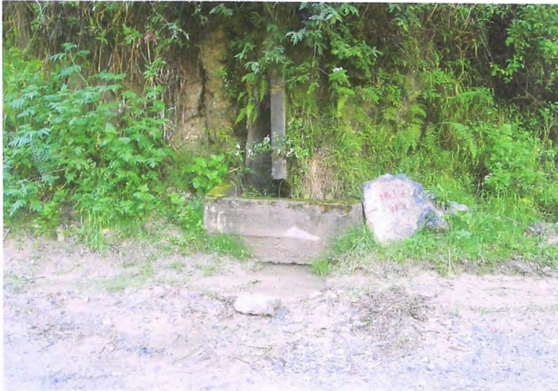
FOTO3: ALCANTARILLA ANTIGUA INSERVIBLE
