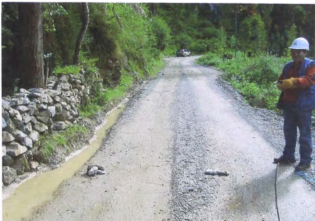
FOTO1: INADECUADO DRENAJE LONGITUDINAL
