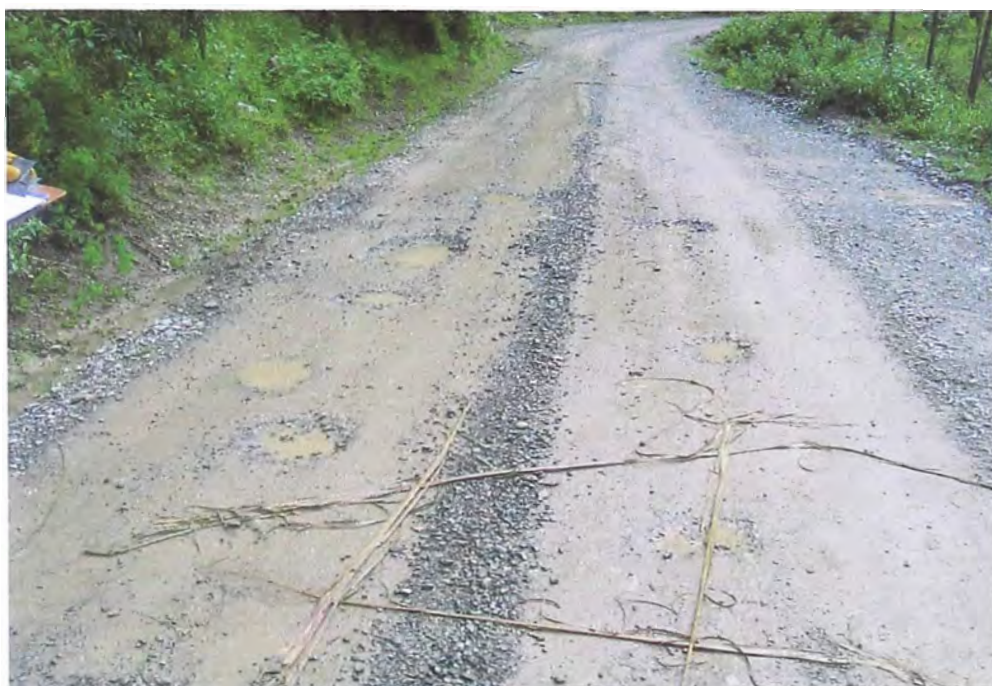
FOTO2: EFECTOS PRODUCIDOS POR DEFICIENTE DRENAJE
