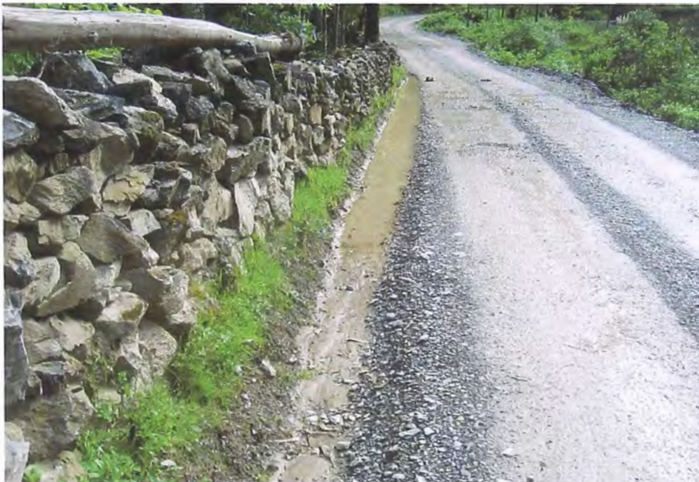
FOTO4: CUNETA MAL DISEÑADA
