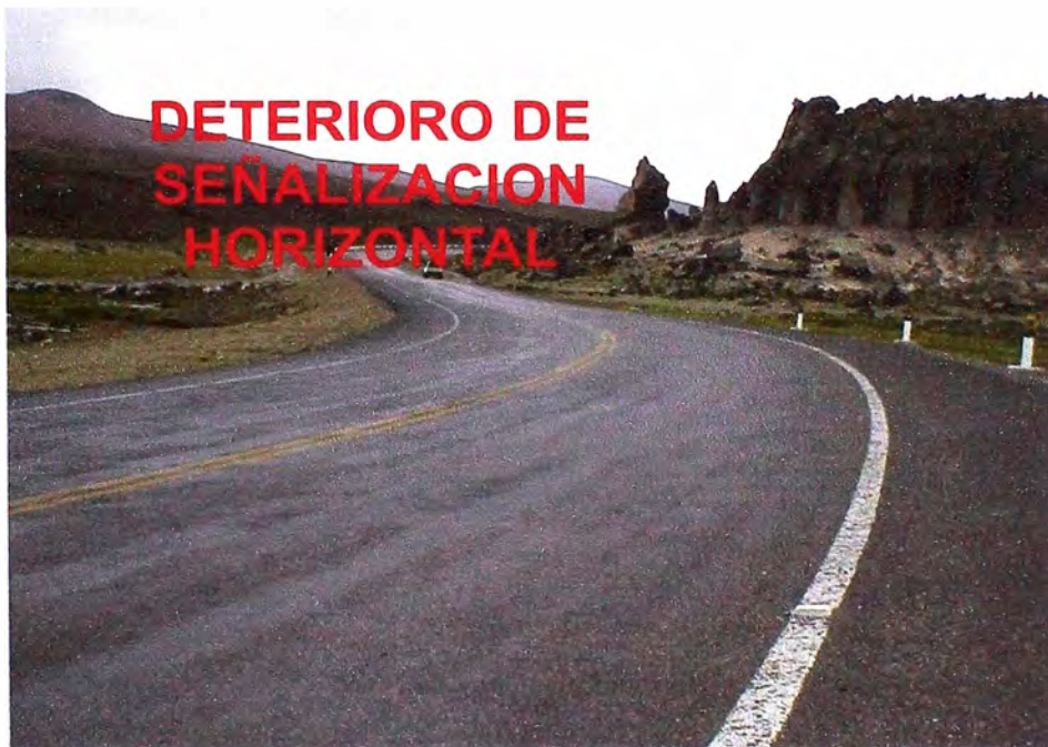
Figura 13: Reposición de marcas en el Pavimento – Deterioro de las marcas.
