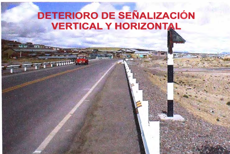
Figura 12: Reposición de Señal Vertical – Deterioro de la señal.
