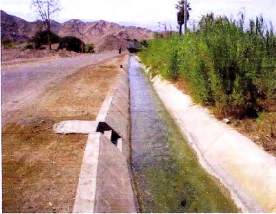
FOTO 2.14 Estado del canal lateral A
