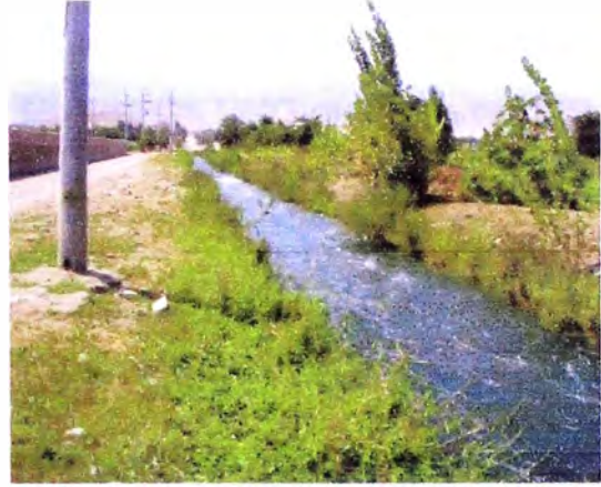
FOTO 2.15 Estado del canal lateral B
