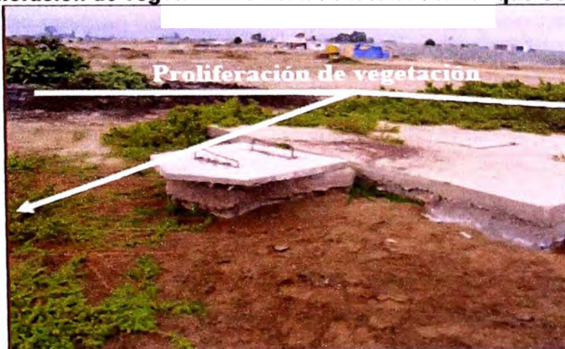
Figura N° 14 Proliferación de vegetación en el lado lateral del Tanque Séptico
