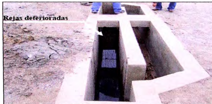
Figura N° 09 Cámara de Rejas, unidad que no cumple su función
