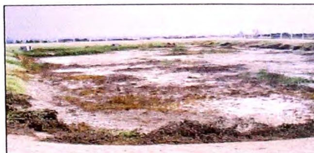
Figura N° 11 Laguna Facultativa Secundaria, se puede apreciar el crecimiento de maleza en casi toda el área
