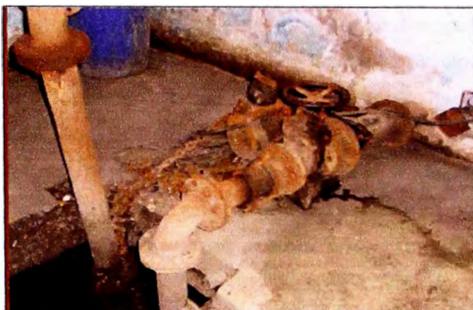
Figura N° 07 Sistema de Impulsión de las Aguas Residuales Sector el Rosario
