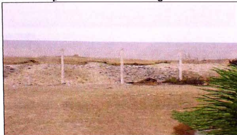
Figura N° 13 Cerco Perimétrico Inadecuado, no tiene alambres de púas que impida el ingreso de personas extrañas al lugar
