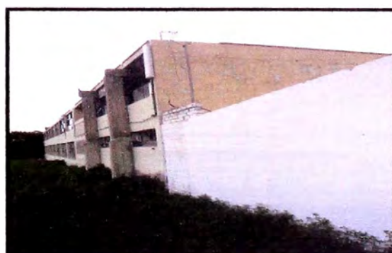
FOTO 2.4.11 Reforzamiento sin asesoría técnica del Instituto Superior.
