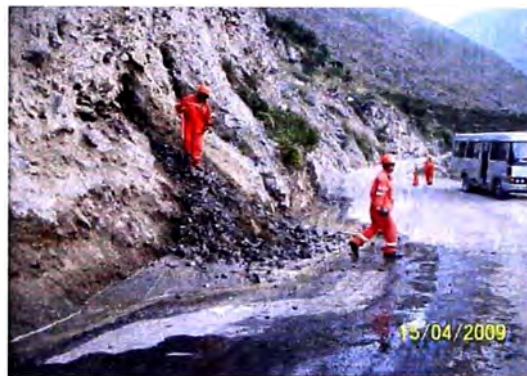
Figura 21: Remoción de derrumbes
