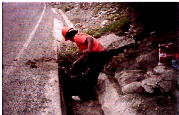
Figura 19: Limpieza de Cunetas revestidas Fuente: Reporte de Supervisión Marzo 2009 - Consorcio Gestión de Carreteras
