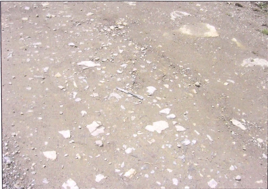
Foto N° 2: Exposición de agregados en la superficie de la vía lo cual ocasiona mala serviciabilidad.
