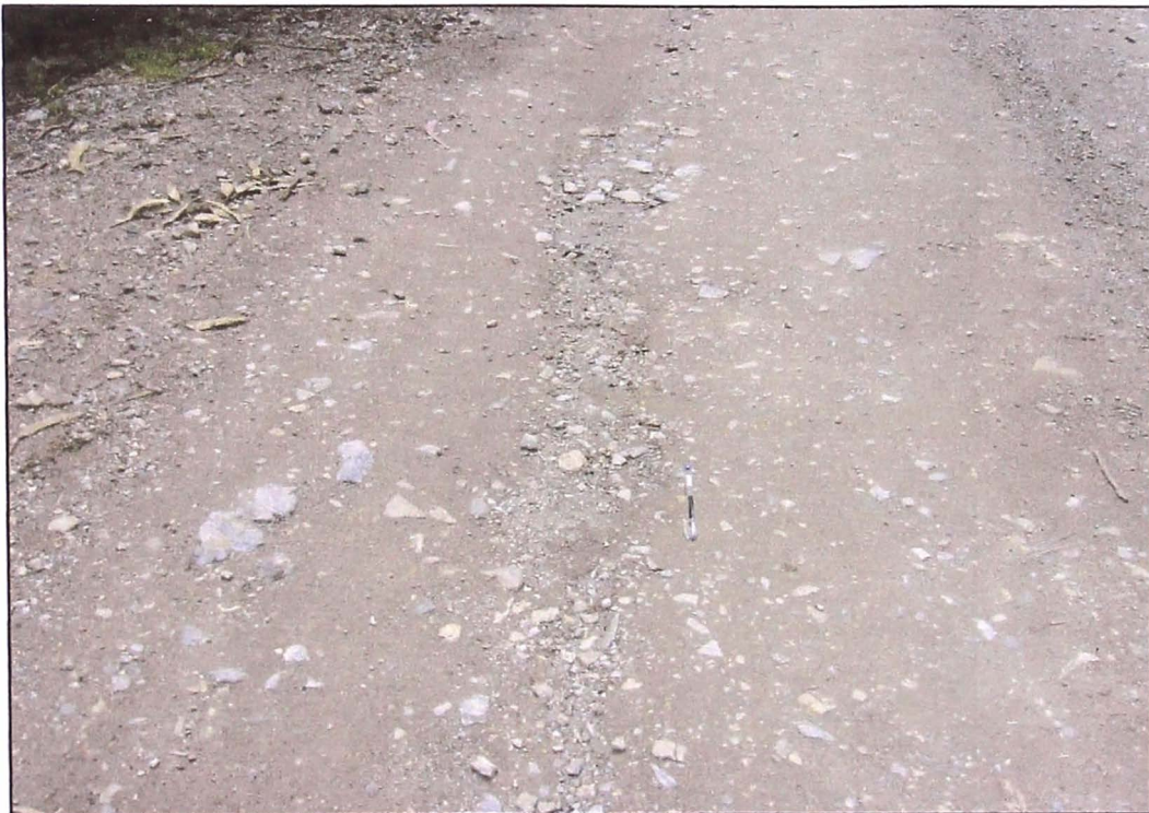
Foto N° 4: El deficiente sistema de drenaje genera que el agua discurra por la actual plataforma que a su vez ocasiona erosión en la plataforma
