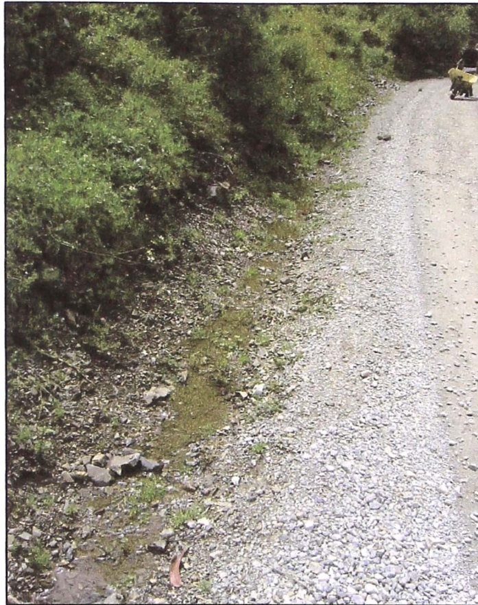
Foto N° 3: La vía cuenta con un deficiente sistema de drenaje el cual esta conformado por cunetas de tierra.
