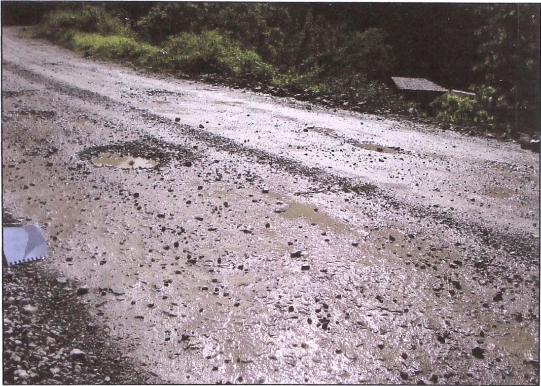
Foto N° 1: Baches existentes en la vía ocasionado por la pérdida de agregados en la superficie la cual genera acumulación de aguas superficiales.
