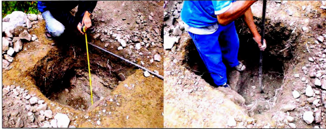
Foto N° 03: Vistas de la calicata C-01, Realizada por el Grupo 4 en la progresiva Km. 163+980. La foto de la izquierda nos muestra que se alcanzó el basamento rocoso.
