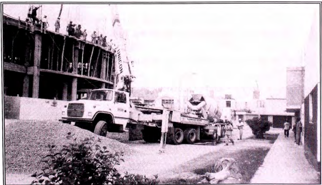
Foto N° 14 Ocupación de vía por camión concretero y bomba de impulsión de concreto premezclado. Únicamente se ejecutó vaciado de premezclado en las losas aligeradas por ser económicamente adecuado.
