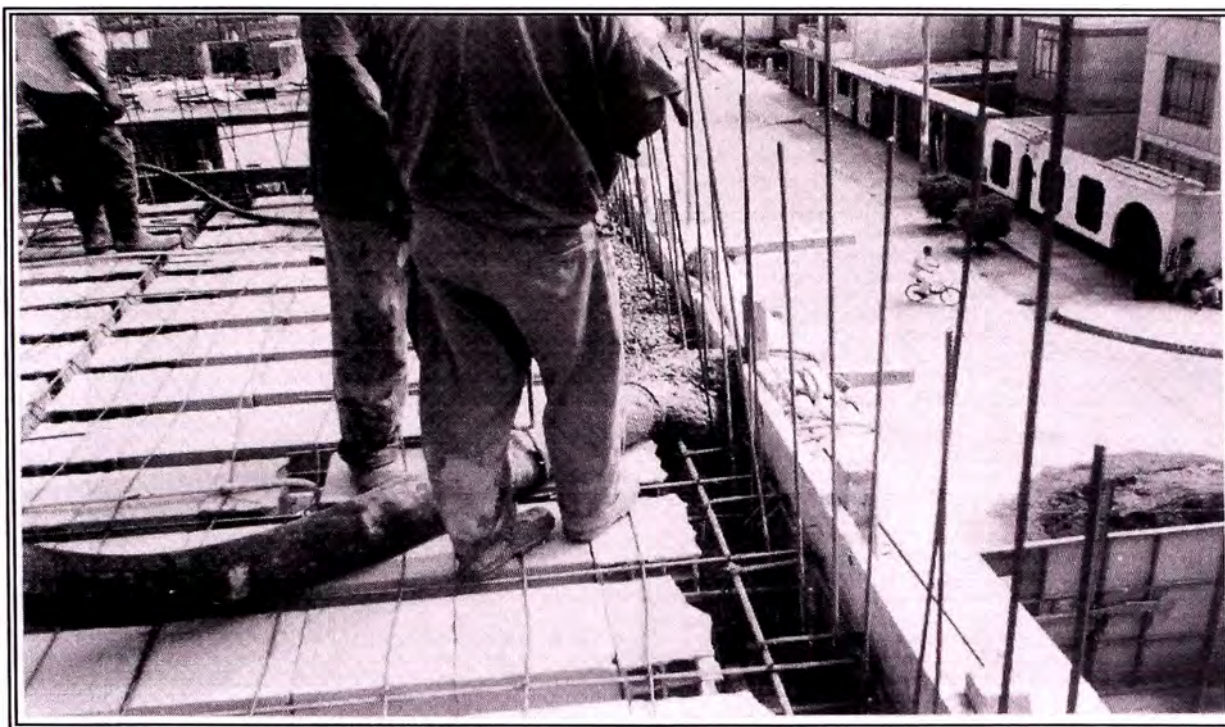
Foto N° 11 Vaciado de concreto premezclado en vigas – 3er Nivel. Se observa que se inicia el vaciado primero en las vigas, y el uso de la vibradora (al fondo).
