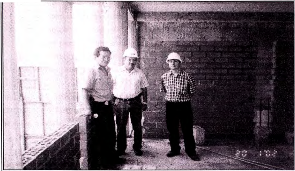
Foto N° 16 Ambiente en módulo derecho en etapa de albañilería. El residente de obra descuidó el uso obligatorio del casco de seguridad.
