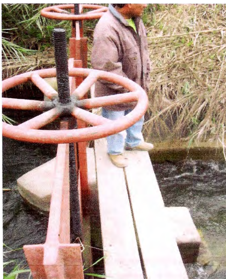
Foto N° 48. Compuertas de ingreso de aguas al canal San Miguel
