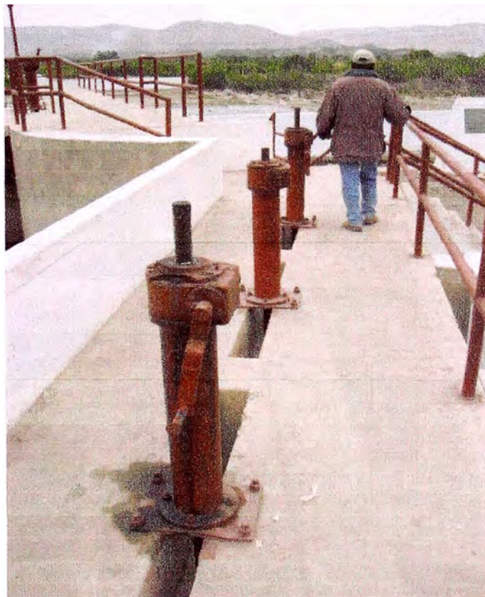
Foto N° 46. Puente de mando. Nótese que solo tiene mayor uso la compuerta en primer plano.
