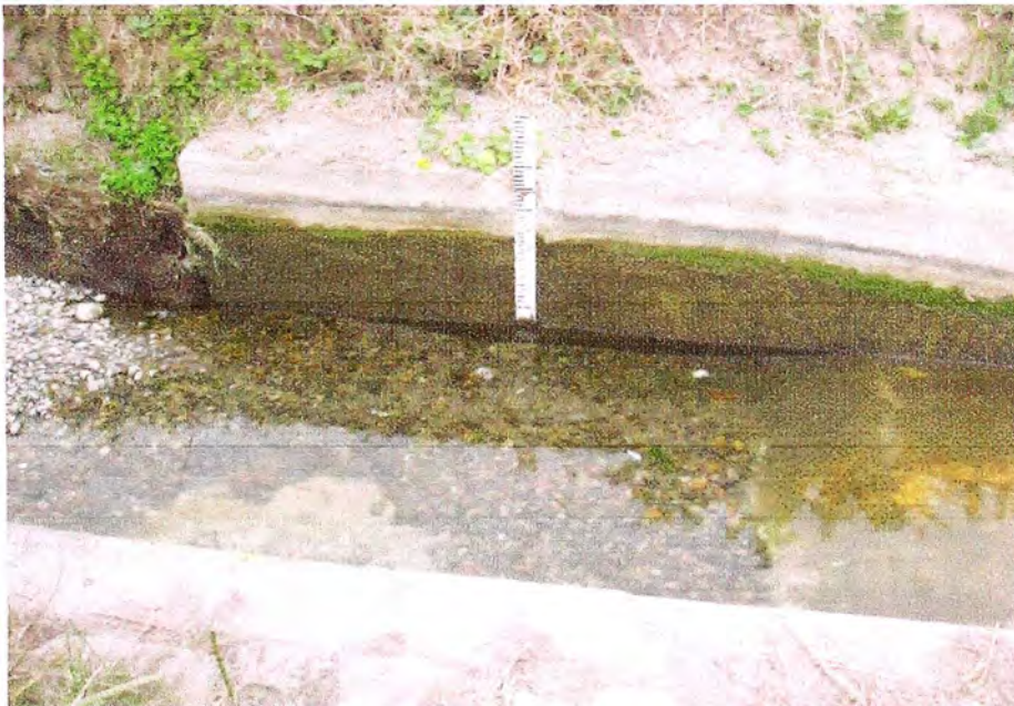
Foto N° 38. Aforador RBC sobre lateral de Canal Huanca cerca de compuerta N°5. Se encuentra en buen estado pero se encuentra con presencia en su fondo de cantos rodados arrastrados por las aguas del río.
