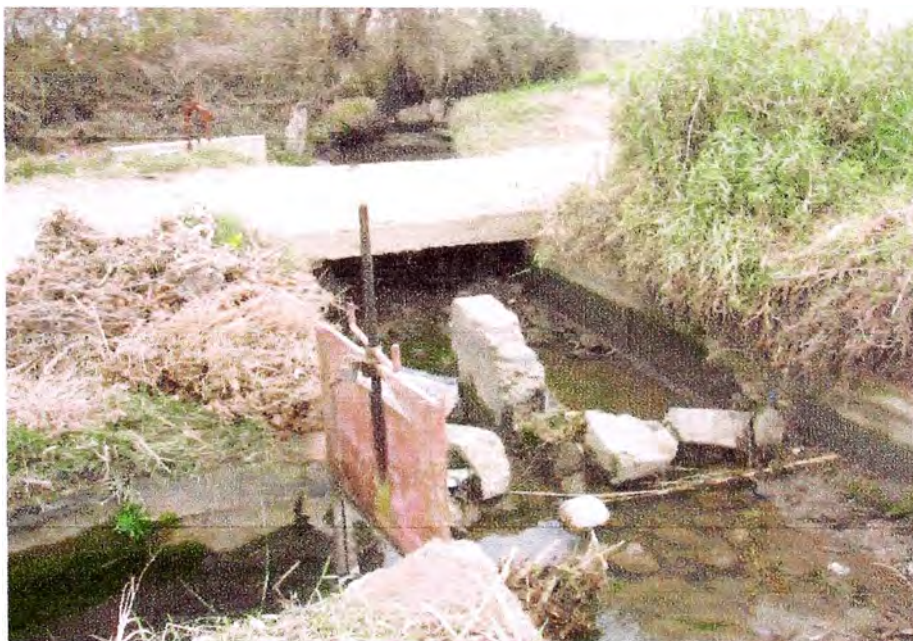
Foto N° 32. Puente Cebada. Captación de las aguas del L1 SM canal Huanca hacia el canal derivador Pachacamilla. El partidor se encuentra en mal estado sin las compuertas que puedan funcionar como check. Ante esta falta algunos usuarios del Canal Pachacamilla echan rocas en el cauce del canal Huanca para que ingrese mayor caudal a su canal lo que genera conflictos.
