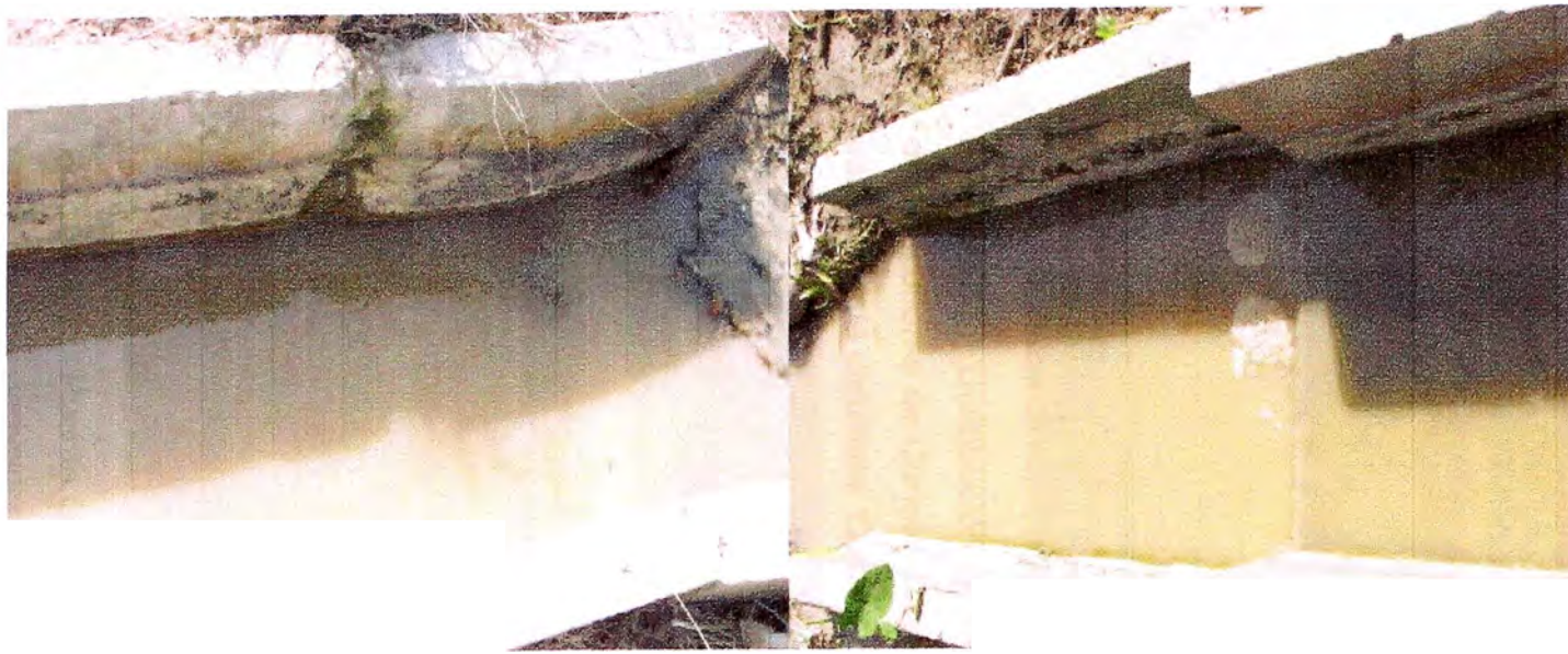
Foto N° 29. Aforador RBC en mal estado de conservación sin regla limnimétrica y con mal mantenimiento.
