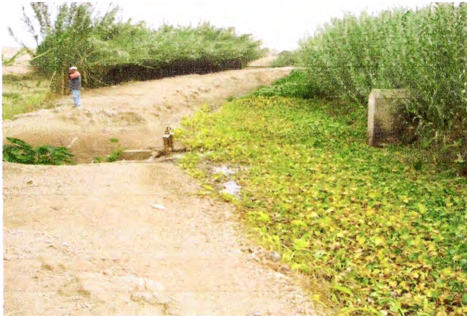
Foto N° 18. Compuerta N° 78 Comité La Charilla. Nótese el gran descuido en temas de limpieza del canal con el crecimiento de plantas acuáticas en el lecho del canal y de caña en el margen derecho. Nótese también la erosión provocada a los costados de la compuerta y la Imposibilidad de tránsito vehicular.
