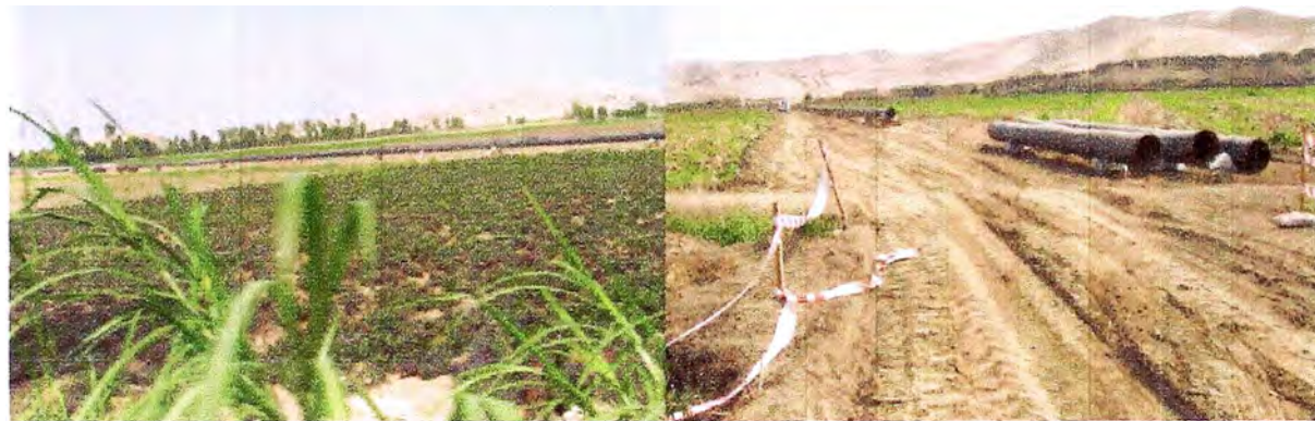
Foto N° 22. Construcción de la segunda tubería de transporte de gas natural hacia el city Gate de Lurín.
