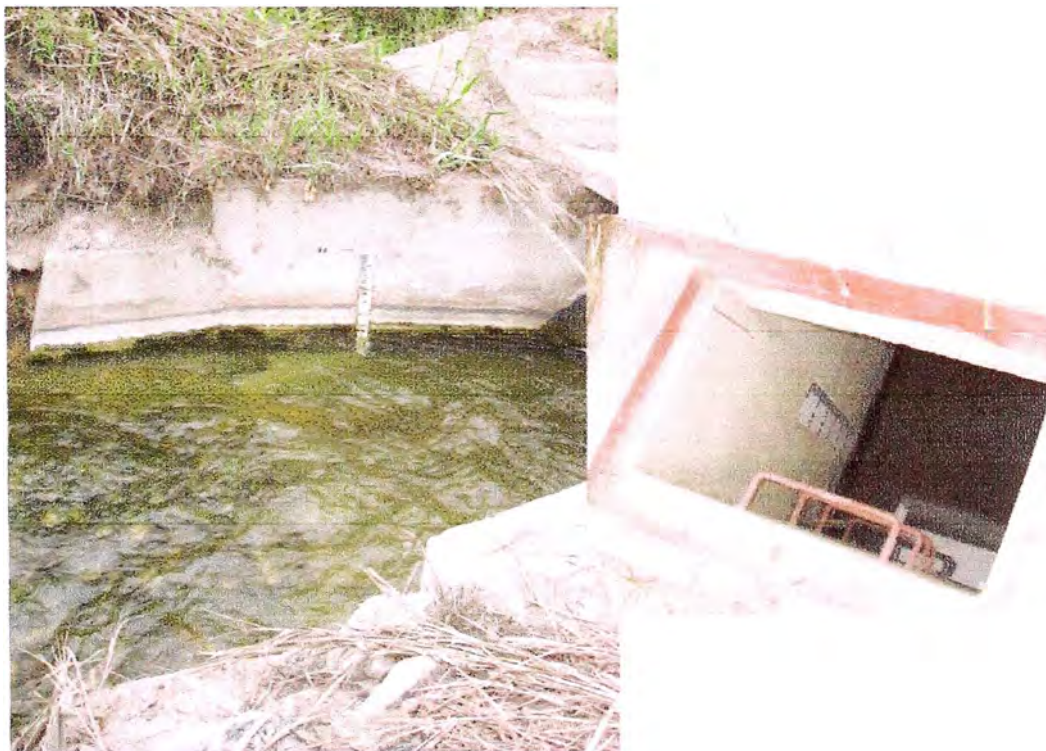
Foto N° 50. Aforador tipo Parshall sobre canal María Angola progresiva 0+206 y poza limnimétrica. Actualmente el limnómetro y el limnógrafo no se encuentran operativos.
