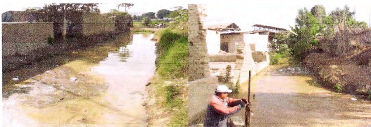
Foto N° 9. Vistas aguas arriba y aguas debajo de la compuerta N° 52. Los árboles que crecen en sus cauces se prolongan por todo el C.P. de La Quebrada. Nótese que un posible desborde puede afectar a las viviendas y campos de cultivo aledaños produciendo incontables pérdidas.
