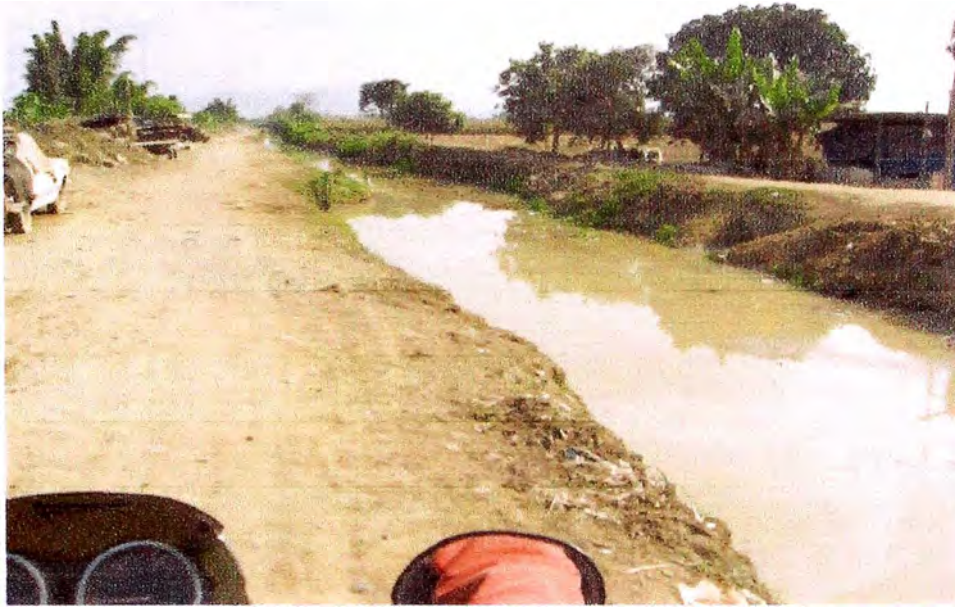
Foto N° 10. Vistas del a Compuerta N° 54 y del canal de drenaje de Imperial al norte del C.P. La Quebrada. Nótese que se encuentran unos 10m desfasados y que no se cuenta con ningún tipo de aliviadero.
