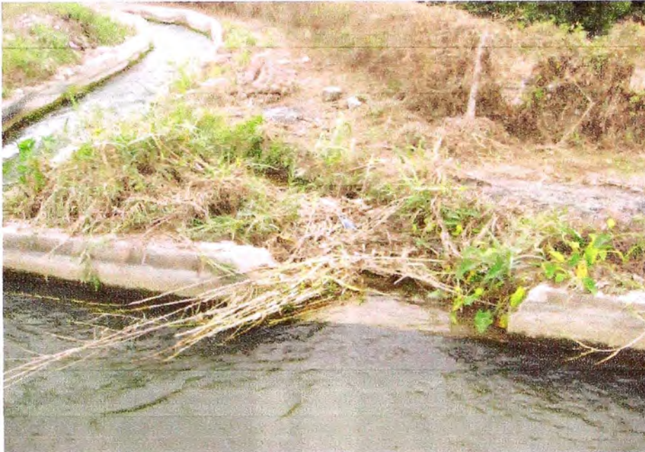
Foto N° 37. Detalle del aliviadero en compuerta N° 5 hacia canal San Miguel obstruido por la maleza.
