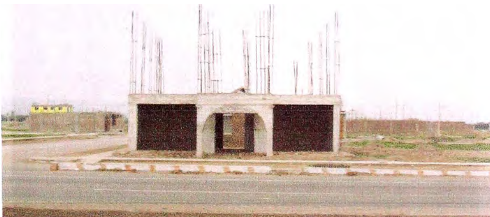
Foto N° 54. Nueva Sede Institucional de la Comisión de Regantes del Canal María Angola. Actualmente se encuentra paralizada por falta de fondos. Carretera San Vicente - Imperial
