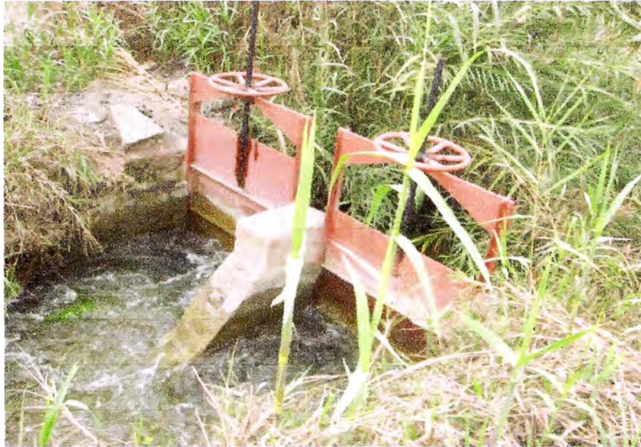
Foto N° 49. Compuertas de ingreso de agua al Canal María Angola
