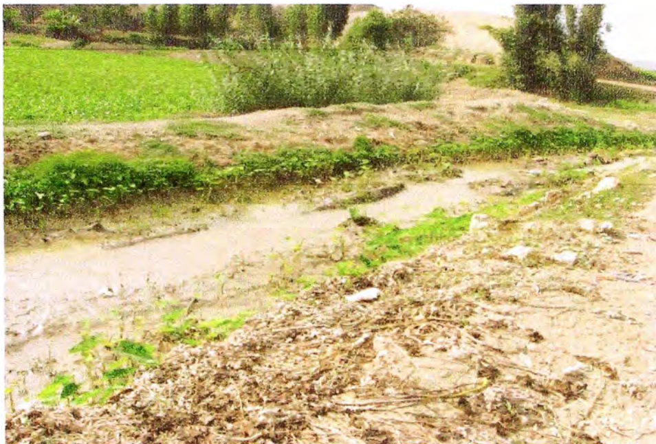
Foto N° 15. Zona alta del Canal María Angola donde el tirante de agua alcanza unos pocos centímetros. Zona de depósito de sedimentos y barro. Compuerta N° 66
