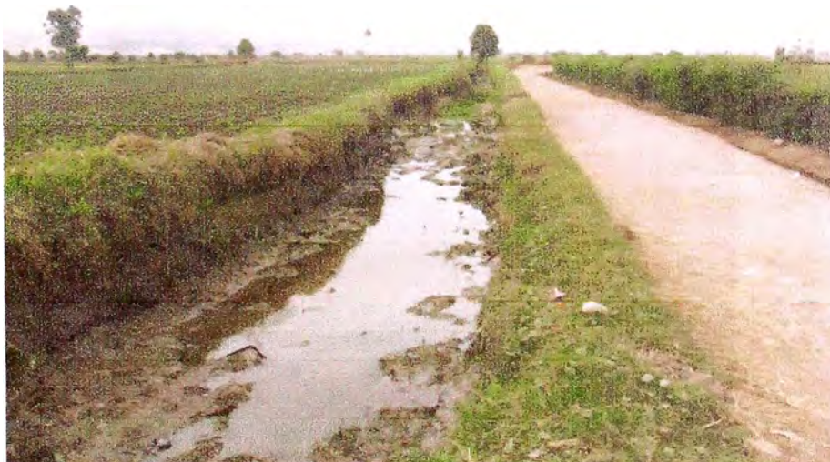
Foto N° 34. Vista del canal Huanca hacia aguas arriba del Puente Cebada, San Vicente de Cañete.
