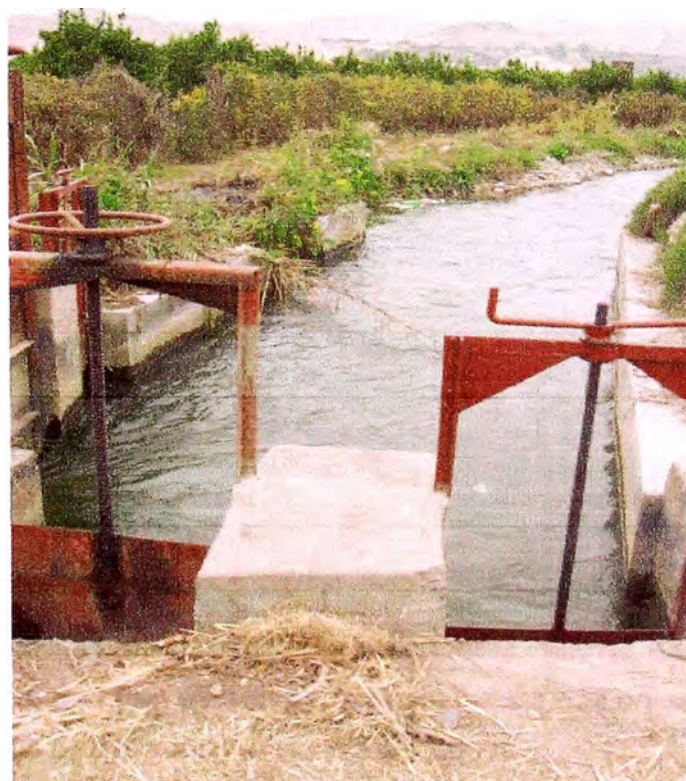
Foto N° 36. Compuerta N° 5 canal San Miguel donde se derivan las aguas al canal Huanca
