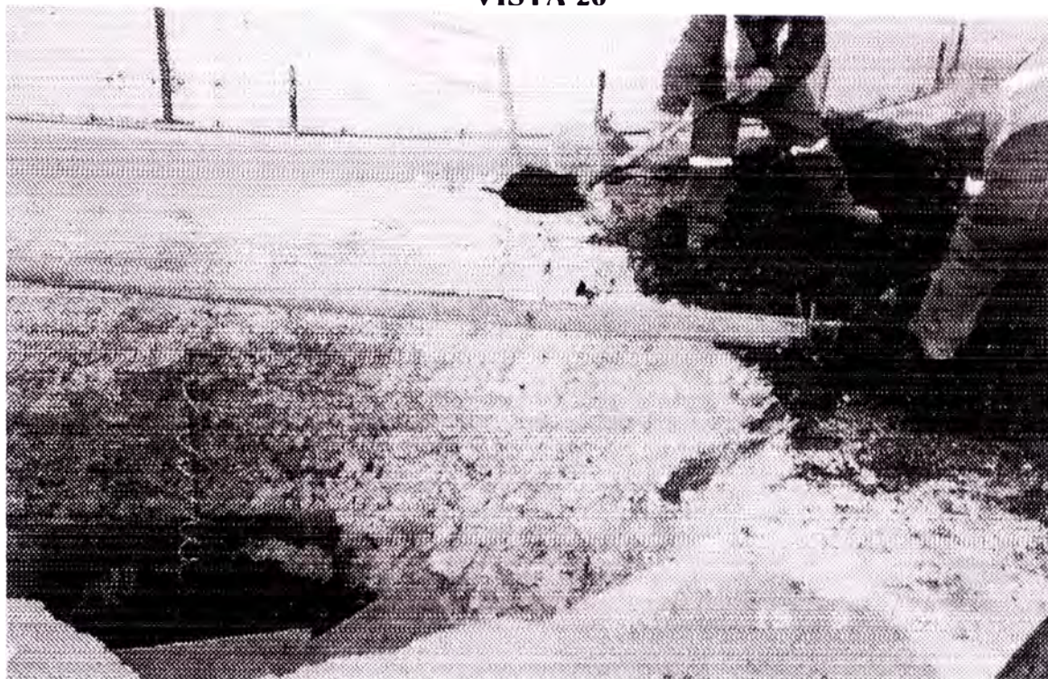
POZOS DE TIERRA: SE APRECIA LA INSTALACION DE BARRA DE COBRE CON BENTONITA Y TIERRA DE CHACRA.
