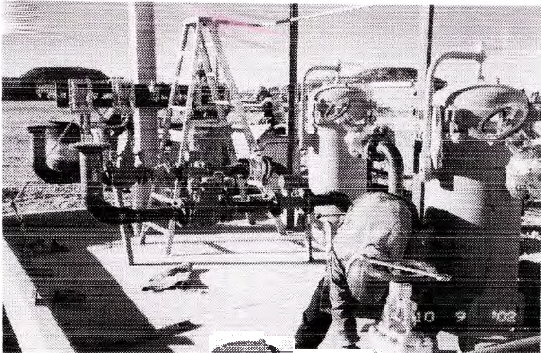
ZONA DEL BOTTOM LOADING: SE APRECIA LA INSTALACION DE EQUIPOS: FILTROS, VALVULAS Y CONTROLADORES DE NIVEL.
