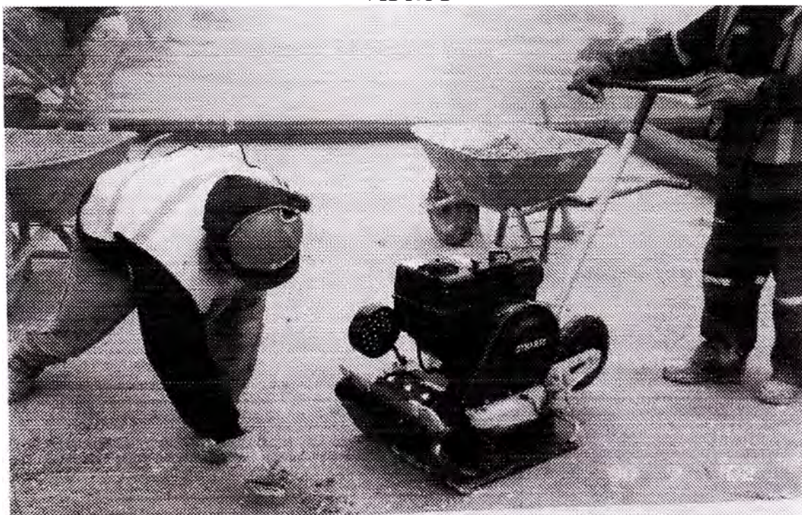
ZONA DE TANQUES: COMPACTACION DE MATERIAL DE RELLENO (SOIL LAINER) PREVIO A LA INSTALACION DE GEOMEMBRANA.
