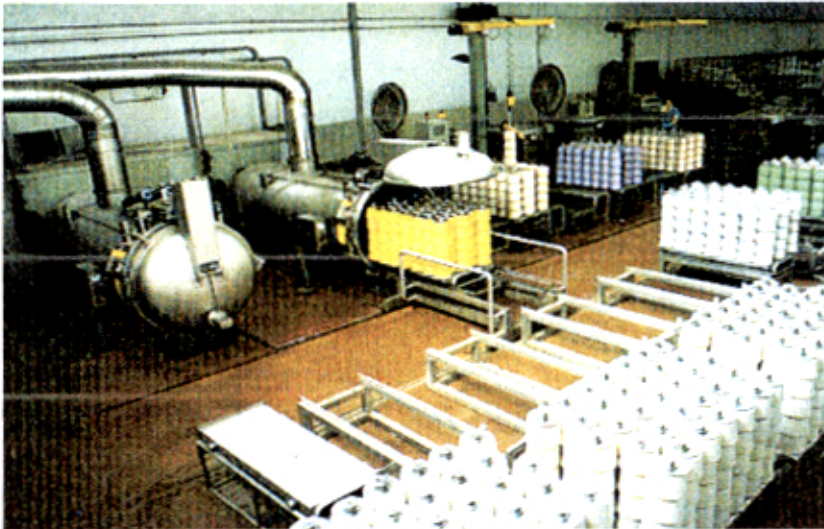
Figura 25. Sistema hidrocolumna en funcionamiento en una gran planta de teñido de hilo.
