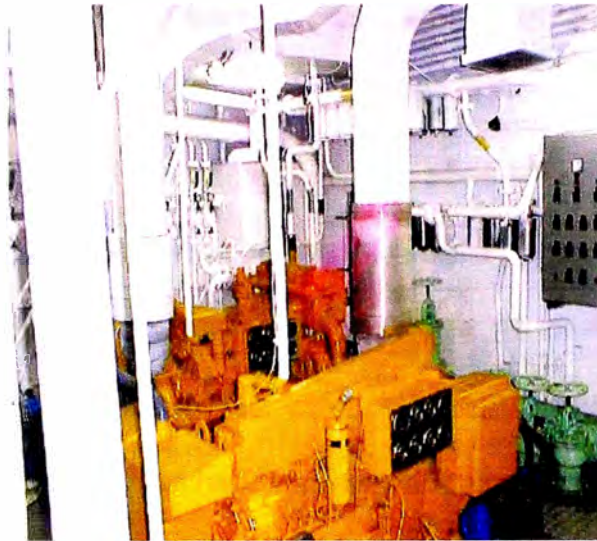
Figura 24. Grupo auxiliar CAT 3406 Instalado, suministra la energía eléctrica para la iluminación, y funcionamiento de las bombas de achique, y el sistema de refrigeración de bodega
