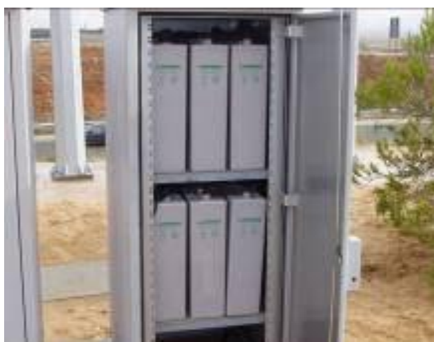
Figura 3.12: Banco de baterías
