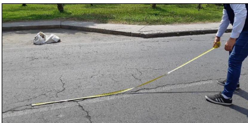
Figura N° 4.13 Grietas longitudinales y transversales
