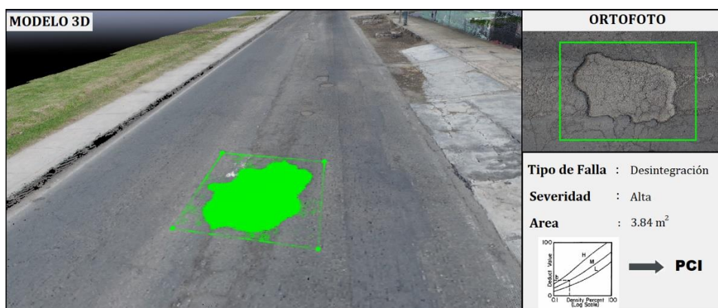
Figura N° 3.15 Identificación de fallas, severidad y metrado
