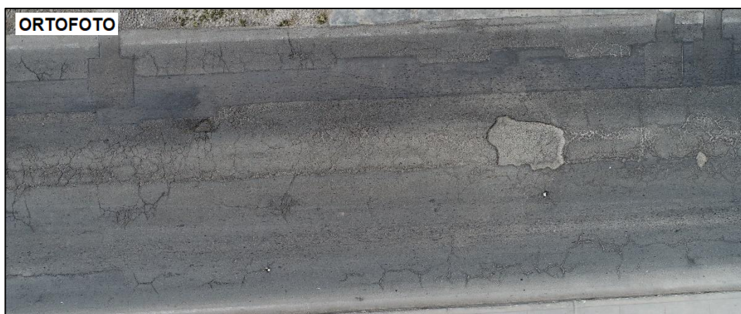
Figura N° 4.31 Fallas en la vía
