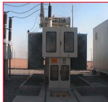
Transformador de Potencia de 20 MW – 23 / 66 kV (S.E. C.S Tacna)
