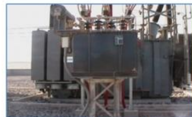
Transformador de 35 MVA – 220 kv
