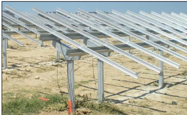
Figura 4.07: Estructura soporte de paneles solares.
