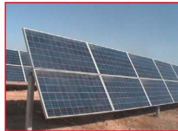
Módulos Solares Instalados
