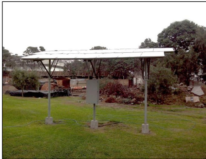
Figura 5.08: Estructura Soporte, Paneles Solares e Inversor.
