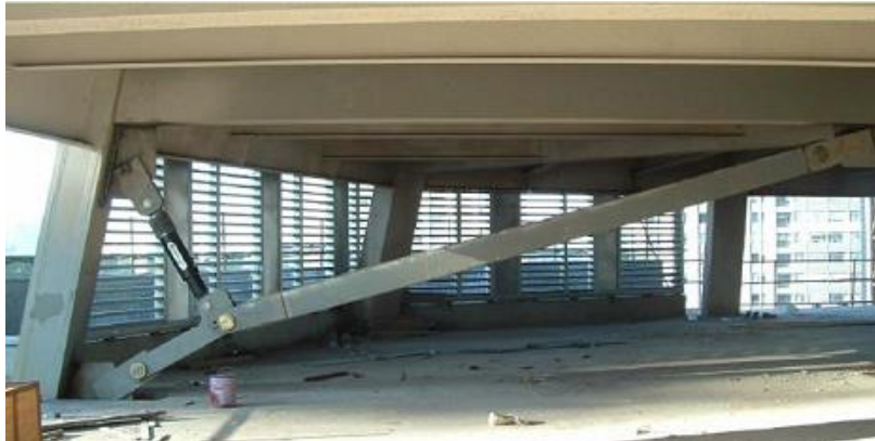
Figura N° 4.13 Disipadores instalados en disposición Upper y Lower Toggle (Taylor Devices)
