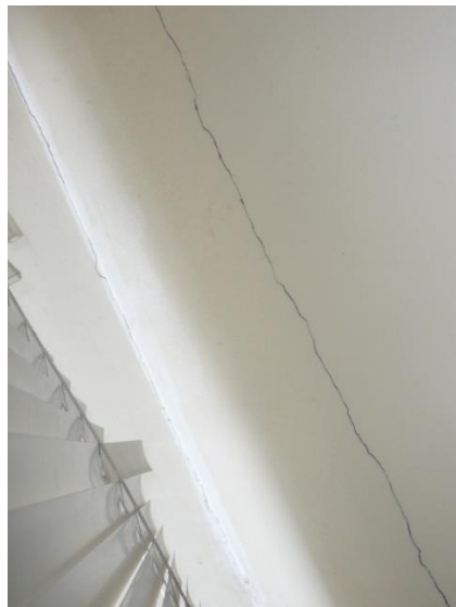
Figura N° 7.3 Presencia de grietas en conexión de muros de albañilería
