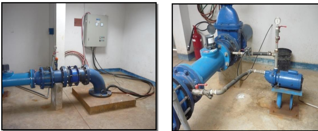
Figura N° 5: Árbol de descarga y Sistema de cloración
