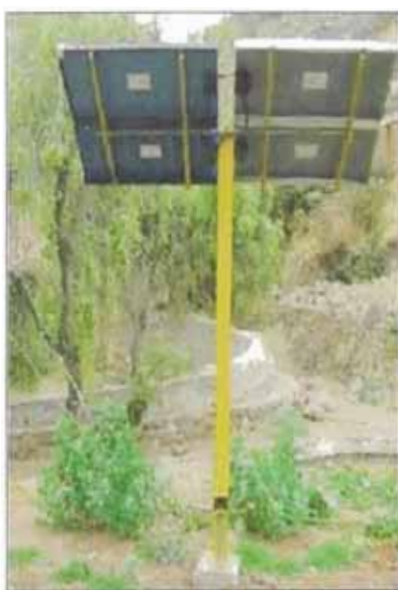
Fig. 16 Generador fotovoltaico al término de la instalación para cargar un banco de cinco baterías de 12 V cada uno.
