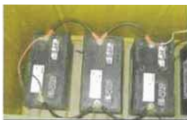
Fig. 6 (Baterías tipo selladas, conectadas en paralelo, 12 V CC de salida; cables de conexión # 2 x 10)
