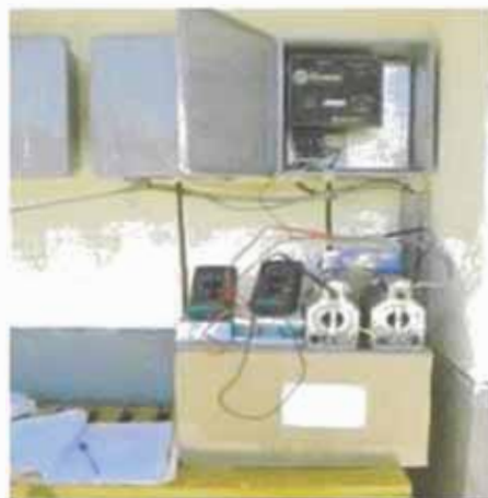
Fig. 20 Conexión eléctrica para la caracterización del generador FV (Controlador, resistencias variables 16 \Omega , resistencia de shunt, multímetros)
