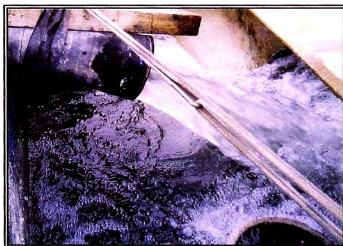
Foto N° 26. En la vista, se aprecia la llegada de la Línea de Impulsión que descarga 20 lps directamente al ingreso del Canal de Mezcla Rápida de la PTAP N°1.
