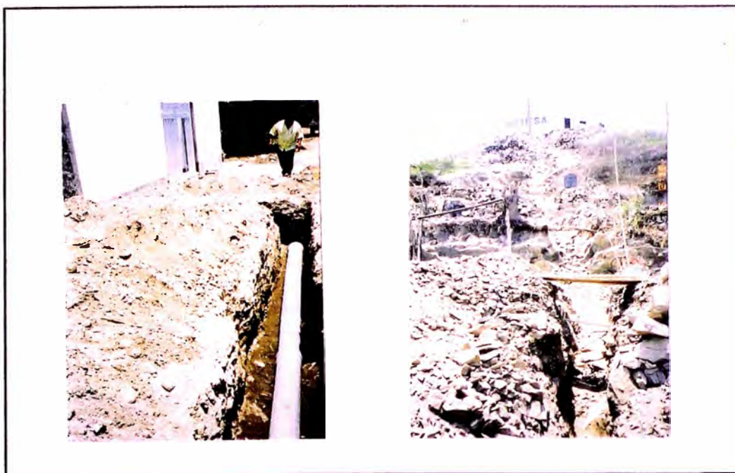
Foto N° 07. En las vistas, se aprecia la instalación de la Línea de Impulsión (tubería Ø 250mm, PVC-U, PN15) que va desde el Pozo N°2 al Reservoirio Apoyado R400.
