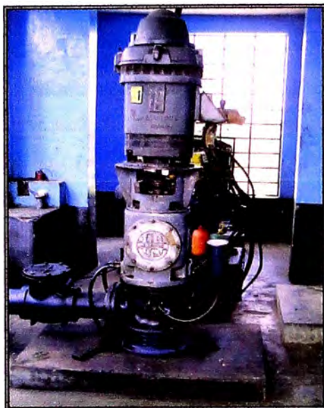
Foto N° 03. En la vista, se aprecia el Equipo de bombeo de Eje Vertical con motor de 60 HP.
