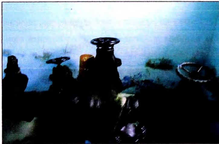
Foto N° 10. En la vista, se ve la Caseta de Válvulas del Reservoirio Apoyado (R-400). Falta mantenimiento. Estado: Regular.
