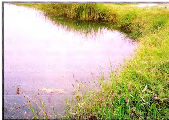
Foto N° 24. En la vista, se ve al Pre-Sedimentador con presencia de maleza en el perímetro. Falta realizar mantenimiento.
