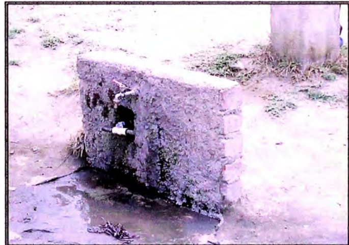
Foto N° 18. En la vista, se aprecia uno de los Pilonos de agua potable. Estado: Regular Ubicación: AA.HH. "Los Olivos".
