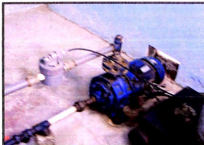
Foto N° 06. En la vista, se aprecia la Electro-Bomba dosificadora que inyecta cloro gas a la salida de la línea de impulsión en el Pozo N° 01.
