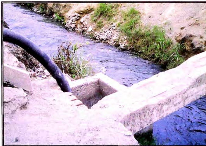
Foto N° 25. En la vista, se aprecia la Captación por Bombeo, ubicada en el Canal Viejo Imperial: Capta un caudal de 20 lps y descarga en el ingreso del canal de Mezcla rápida de la PTAP N°1.
