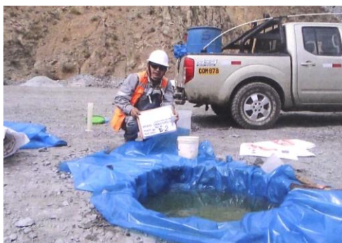
Figura N°5-10: Ejecución de ensayo de densidad in situ con el método del reemplazo con agua (ASTM D5030)
