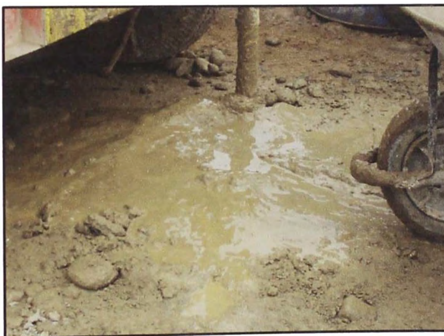
Fotografía: Desperdicio de agua con cemento de la mezcladora durante el proceso de batido.
