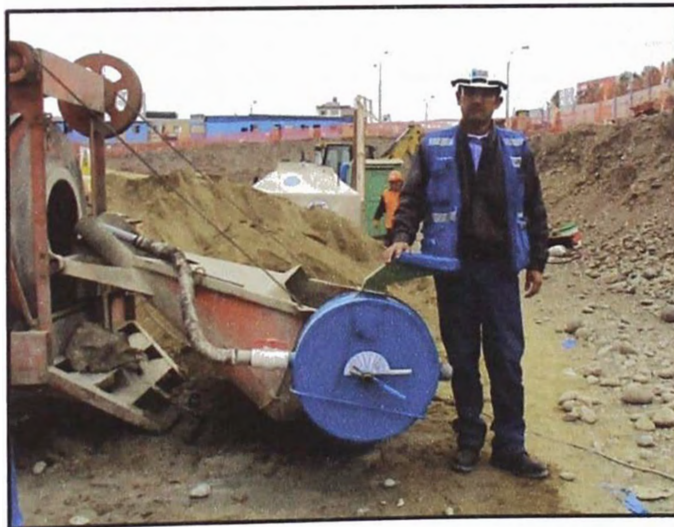
Foto 4.2.2.b: Dosificador de Agua instalado
