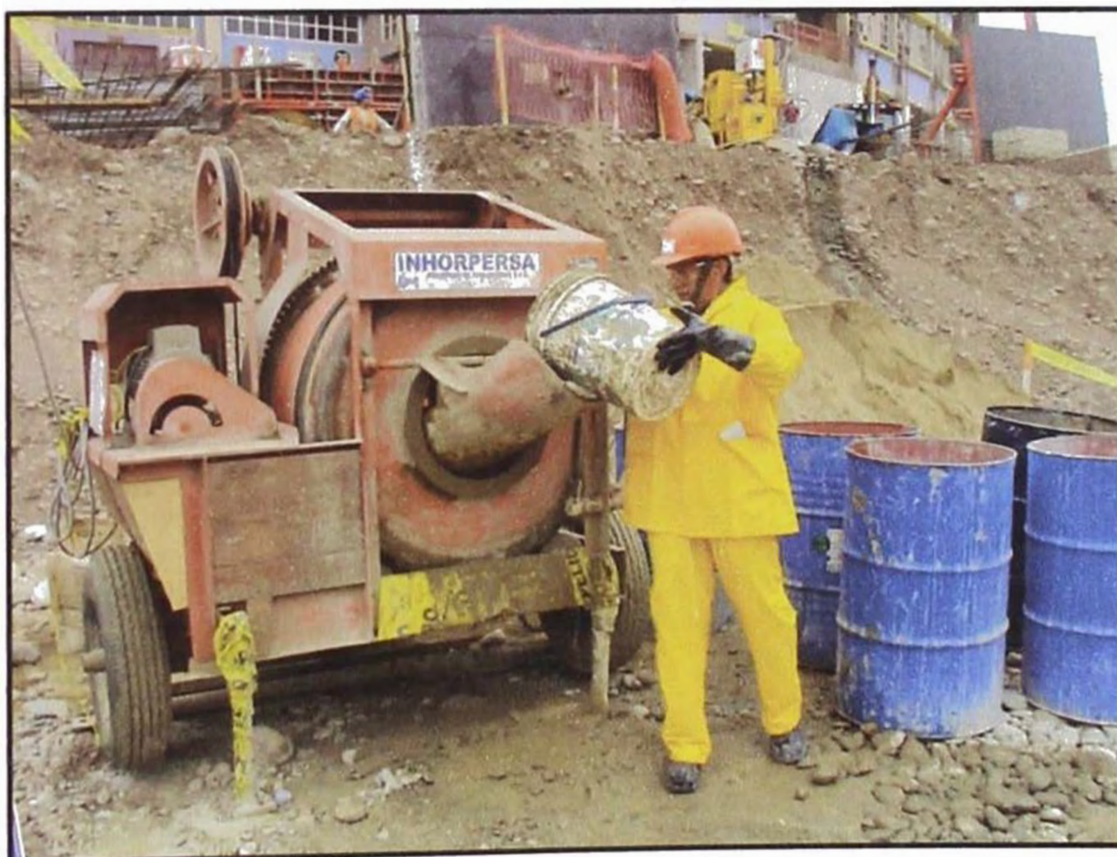
Fotografía: Operario Maquinista abasteciendo de agua por chute de evacuación de la mezcladora
