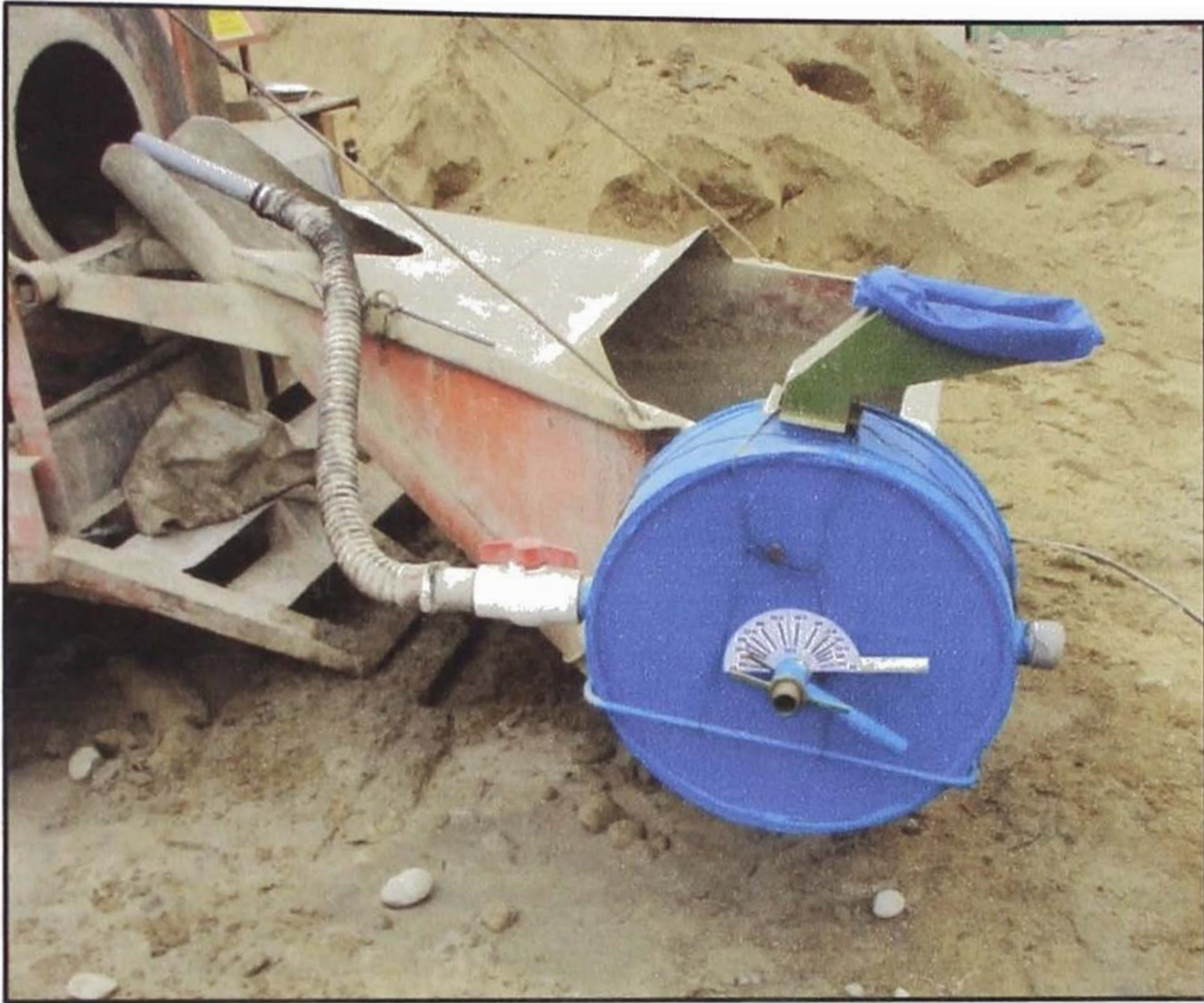
Foto 4.2.3: Dosificador de agua instalado en tolva de mezcladora
