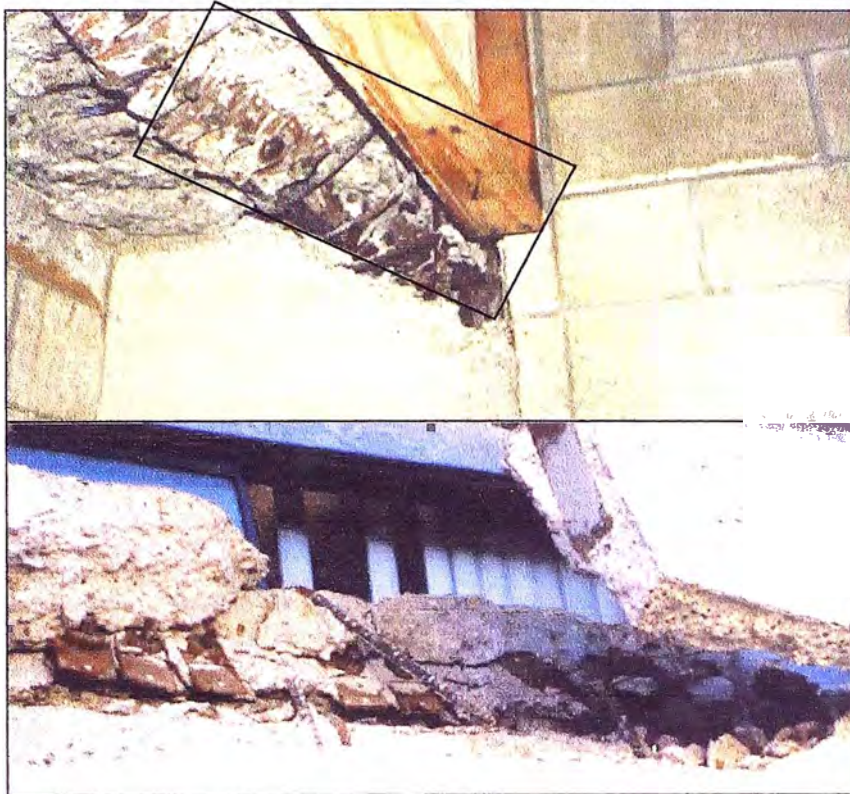
Figura 1.12 Anclajes de postensado no adherido luego de sismo (8)
