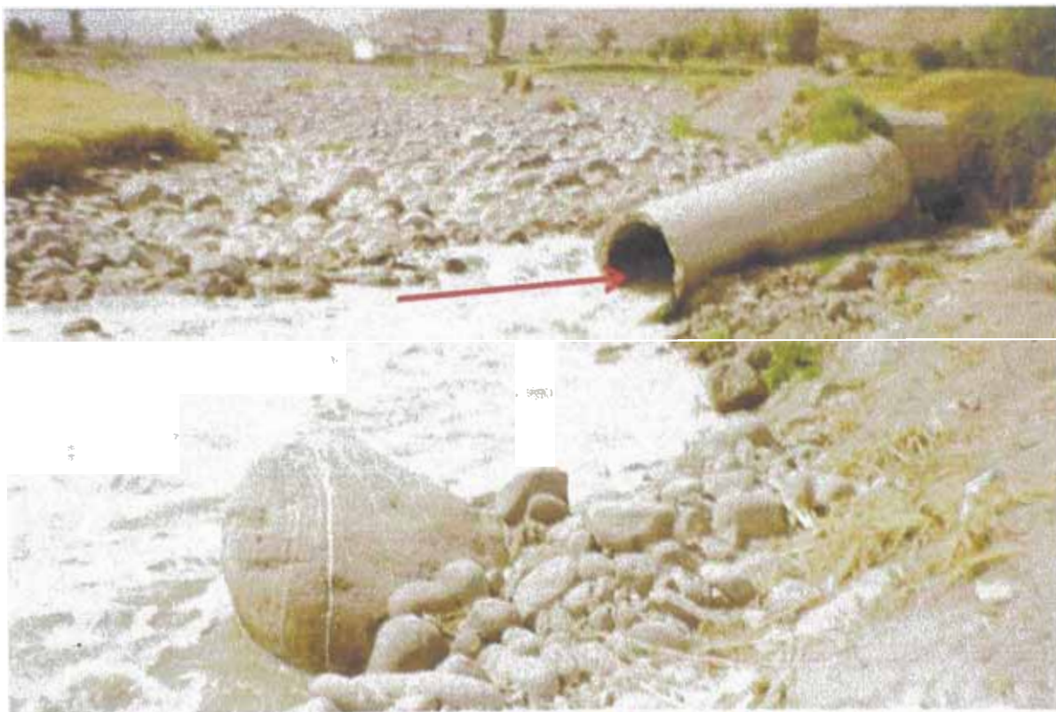
FOTO N° 10. Tubería de desague destruido en parte, en la margen izquierda del río Chili en el sector de Alata. Nótese la turbidez del agua.
