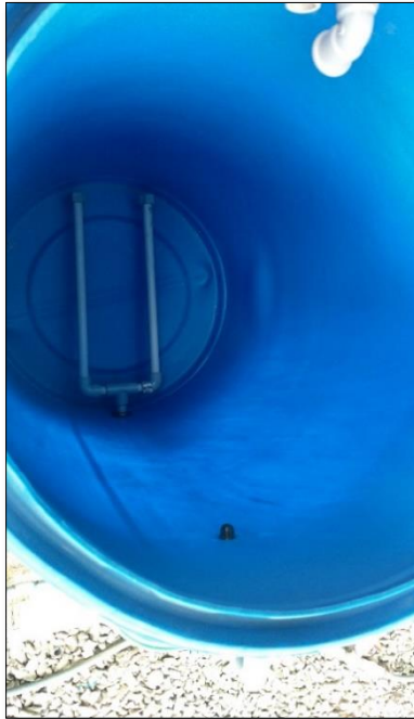
Fotografía N° 3 Sistema de drenaje del FLA N°2
