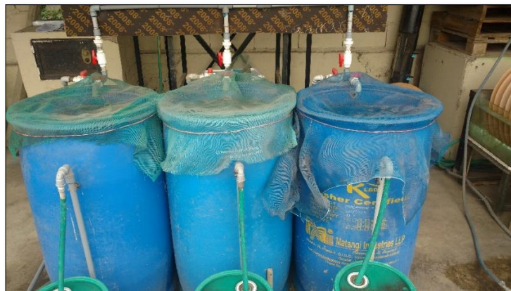
Fotografía N° 7 Protección de los FLA con mallas mosquiteras
