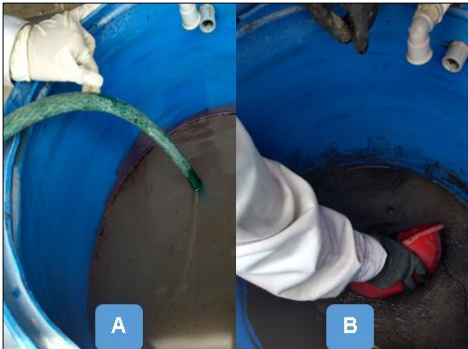
Fotografía N° 19 Limpieza y evacuación por sifoneo del agua del FLA (A), retiro del medio filtrante colmatado (B)
