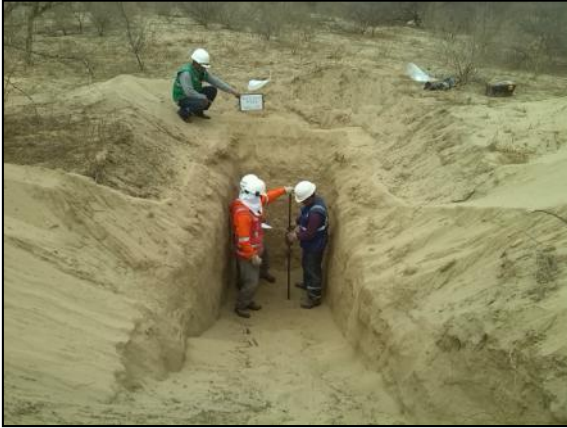
Foto 5. DPL-2 de 1.40 m. de penetración, realizado en un calicata de 2.00 m de profundidad, ubicado en PTAP
