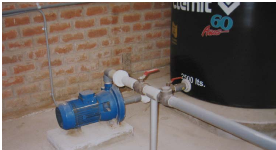
Bomba de agua B-1 y Tanque TA-1.
