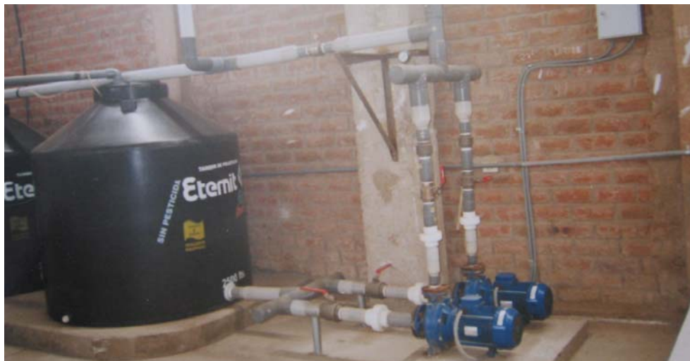
Bombas de agua B-2 y B-3, y Tanque TA -2.
