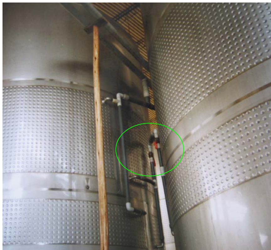
Figura1.9. Válvula de ingreso de agua de refrigeración a la chaqueta del tanque de fermentación de la derecha.
