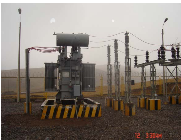
FIG 6.15 Muestra el transformador de 6 MVA, 50/10.5 KV, en pleno funcionamiento en la Subestación Marcapunta Oeste
