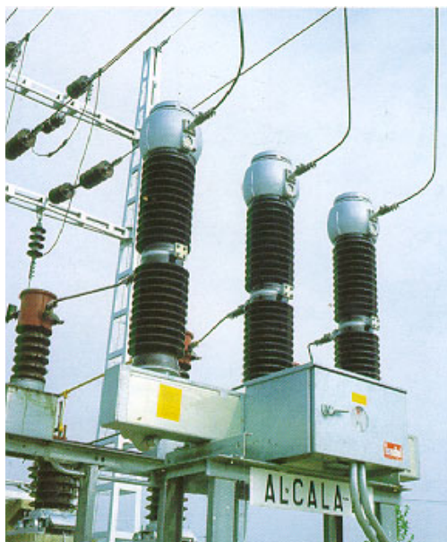
FIG. 6.4 Transformador de Corriente
