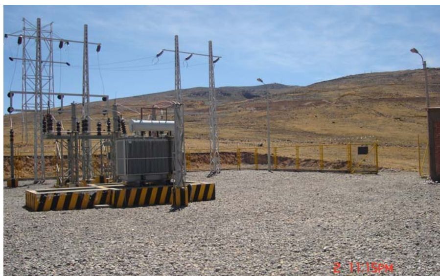
Figura 3.1 Subestación Marcapunta Oeste
