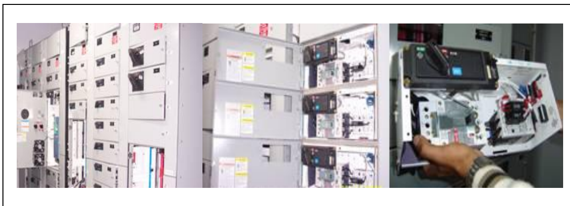
Fig. 4.12 Centro de Control de Motores - CCM's. [12], [26]
