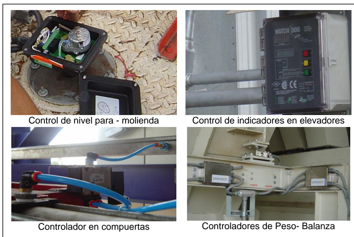
Fig. 4.9 Sensores y Actuadores – Control Centralizado en la Producción. [12]
