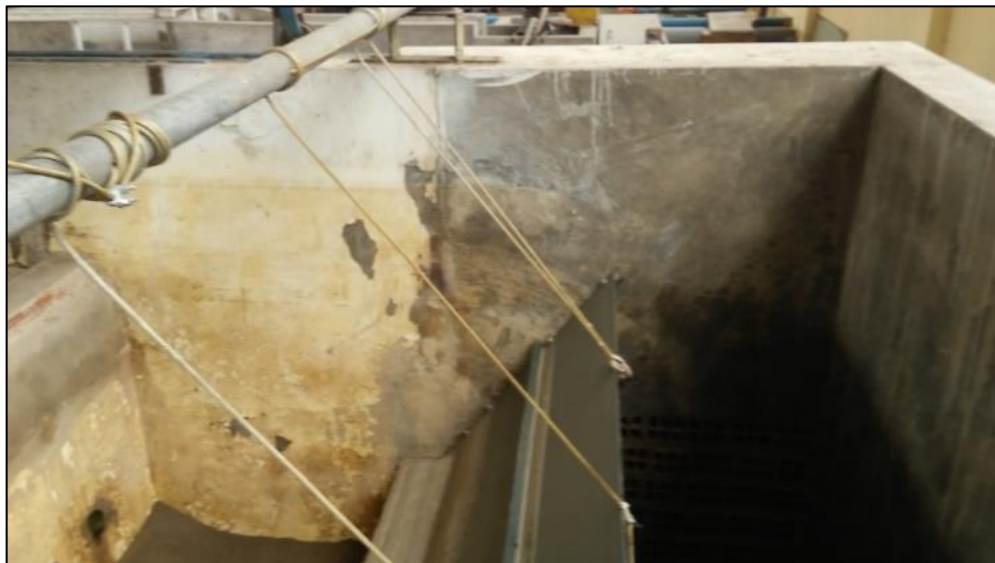
Figura N° 3.5 Poza de salida y compuerta clapeta. Fuente: Propia
