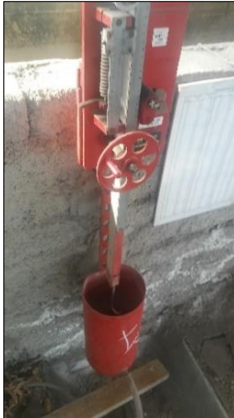
Figura N° 3.7 Limnómetro para medición de caudales. Fuente: Propia
