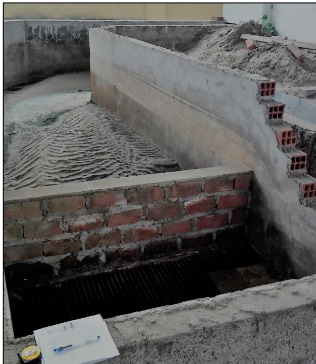
Figura N° 3.6 Canal de retorno. Fuente: Propia
