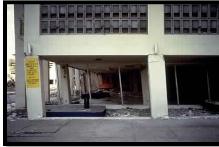
Figura N° 2.23 Falla del edificio Casa Micasa durante el sismo de Managua, 1972. Debido a la presencia de piso blando en el primer piso
