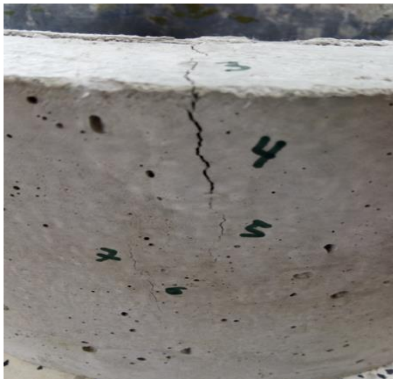
Figura N°F.0.26. Conteo de fisuras laterales.
