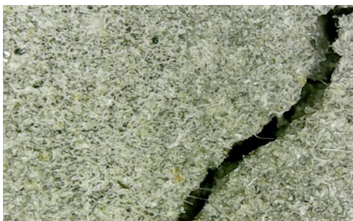
Figura N° 7.16. Fisura superficial del concreto con fibra ultrafina 400 g/m 3 , captada con el microscopio AMCap
