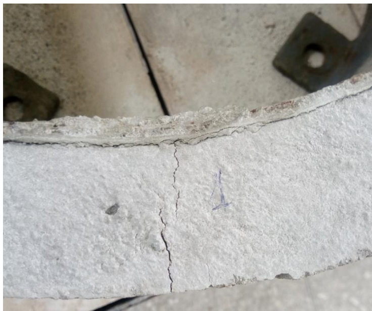
Figura N° 7.15. Fisuras superficiales y laterales enumeradas.
