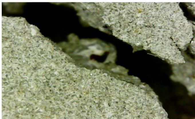
Figura N° 7.8. Fisura lateral del concreto patrón, captada con el microscopio AMCap
