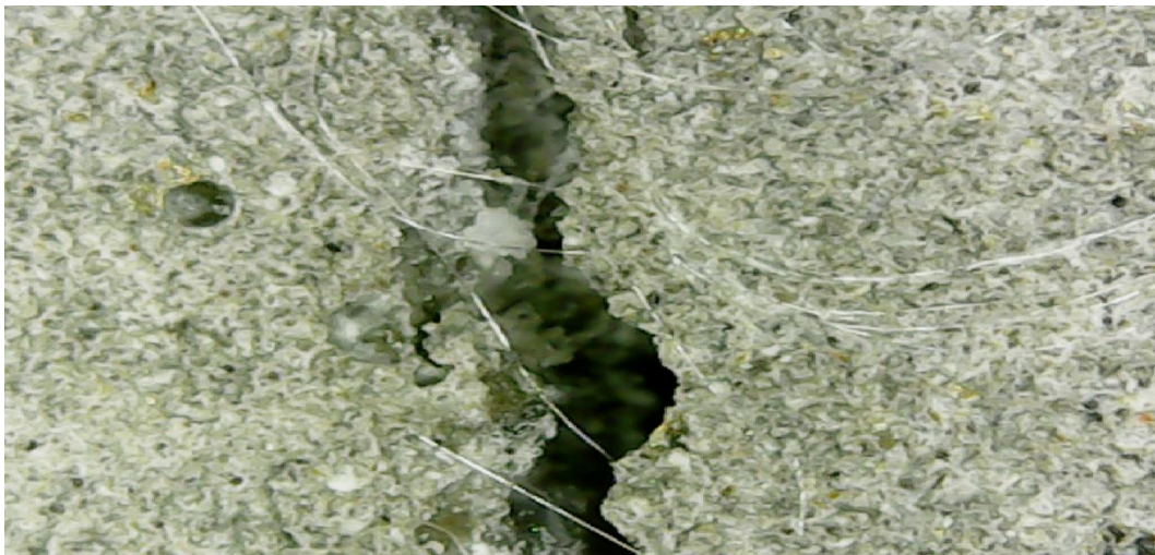
Figura N° F.0.30. Fisura lateral del concreto con fibra ultrafina 400 g/m 3 , captada con el microscopio AMCap
