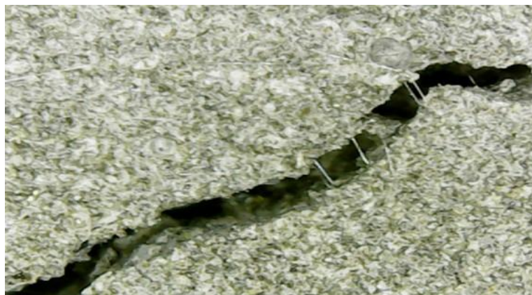
Figura N° 7.11. Fisura lateral del concreto con fibra ultrafina 200 g/m 3 , captada con el microscopio AMCap
