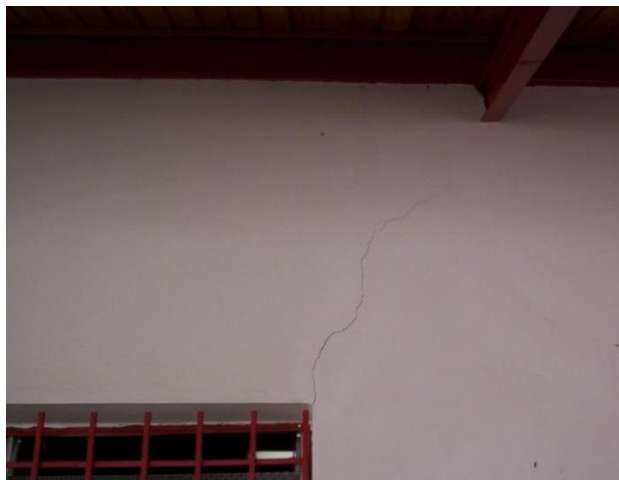
Figura N° 3.2. Fisura frecuente en esquinas de ventanas y puertas
