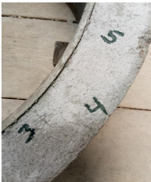
Figura N° 7.12. Fisuras superficiales y laterales enumeradas. Fuente: Fotografía Propia
