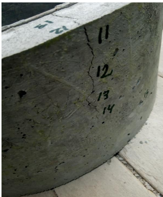
Figura N° 7.9. Fisuras superficiales y laterales enumeradas.
