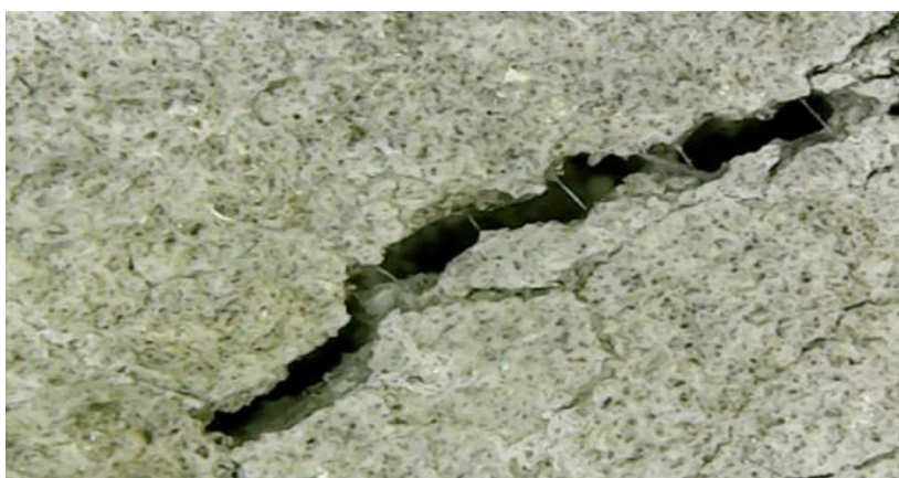
Figura N° 7.13. Fisura superficial del concreto con fibra ultrafina 300 g/m 3 , captada con el microscopio AMCap Fuente: Fotografía Propia
