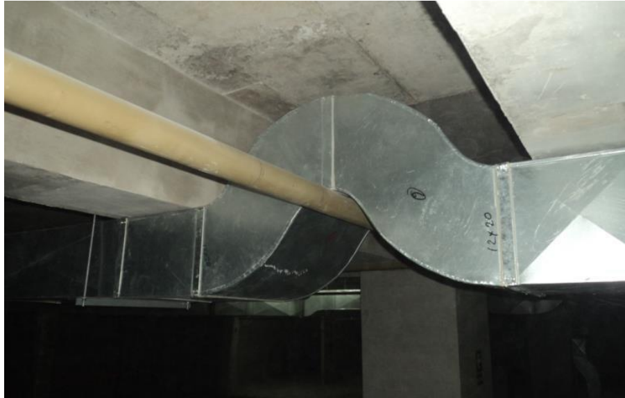
Figura 1: Interferencia entre ducto HVAC y tubería de ACI (Fuente: Alcántara, 2013)
