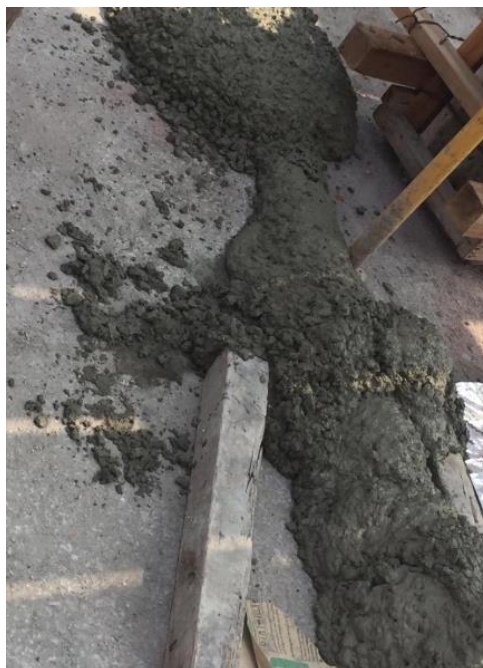
Figura N° 30 Desperdicio de concreto por acople en las tuberías
