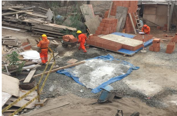
Figura N° 32 Concreto Remanente en la bomba pluma
