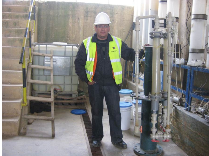
FIGURA N° 1.5 EQUIPO DE PRUEBAS PILOTO (COMARSA)
