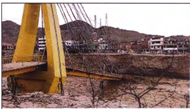
Figura N° 2.10: Colapso del Puente Talavera (Fuente: Diario el Comercio, 2017)
