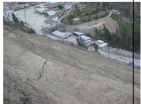
Figura 0.58 Grietas longitudinales y paralelas al talud de la carretera en el reperfilamiento
