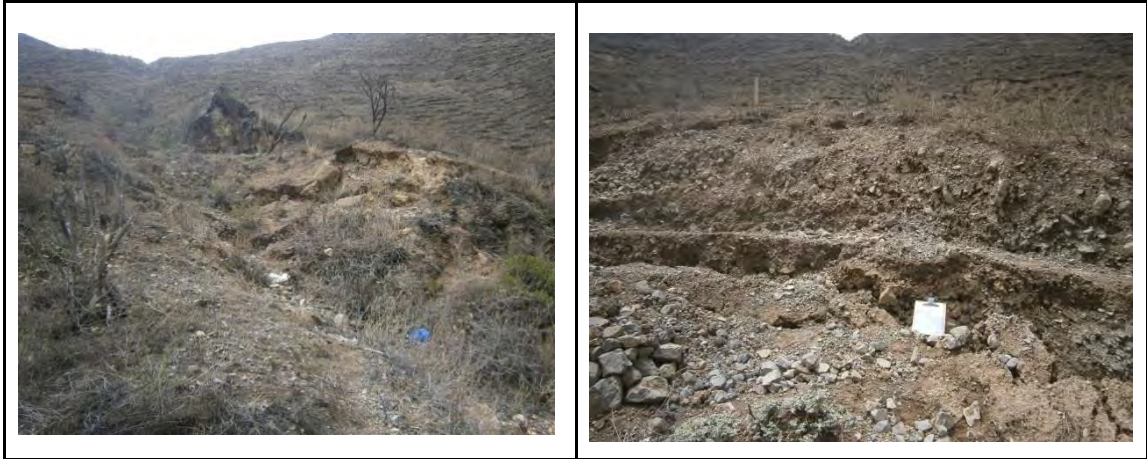
Figura 0.7 Escarpa y grietas en el material de alta permeabilidad situado en la cabecera
