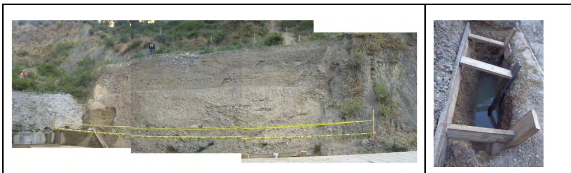
Figura 0.2 Flujos de agua en las paredes de calicata en el plano de deslizamiento
