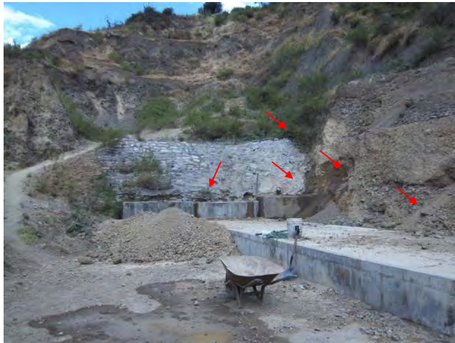
Figura 0.4 Diversos puntos de filtraciones de agua en la zona del portal del túnel
