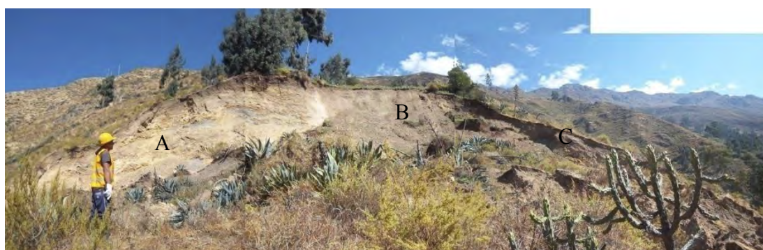
Figura 0.6 Vista de la corona de deslizamiento y del material deslizado en agosto 2011
