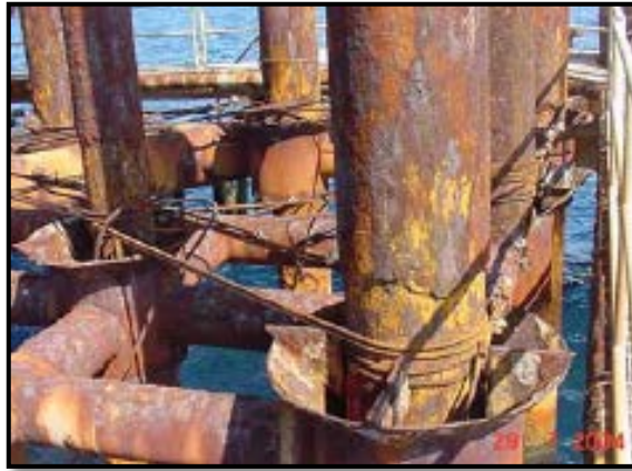
Figura 31: Corrosión. Fuente: CIP 1 - NACE, 2014, Pág.103.
