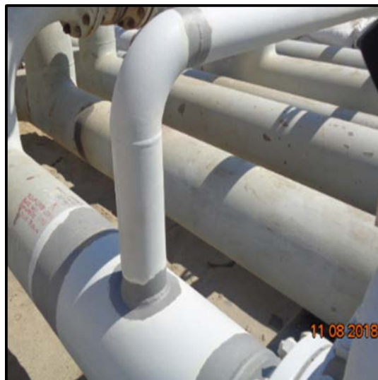
Figura 27: Preparación de superficie en juntas de soldadura de tubería. Fuente: Elaboración propia.
