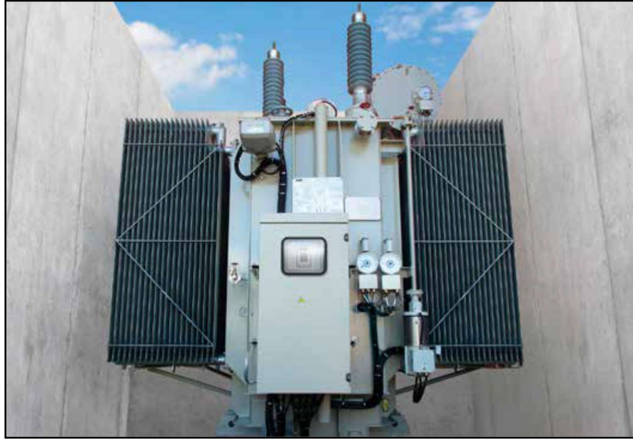
Fig. 2.4 Transformador con núcleo en aceite [Fuente: ABB, Equipos de MV, ABB Library,2020]
