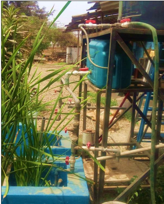
Fotografía N° 6: Tanque regulador de nivel de agua residual.
