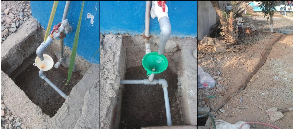
Fotografía N° 11: Sistema de recolección y conducción del efluente.
