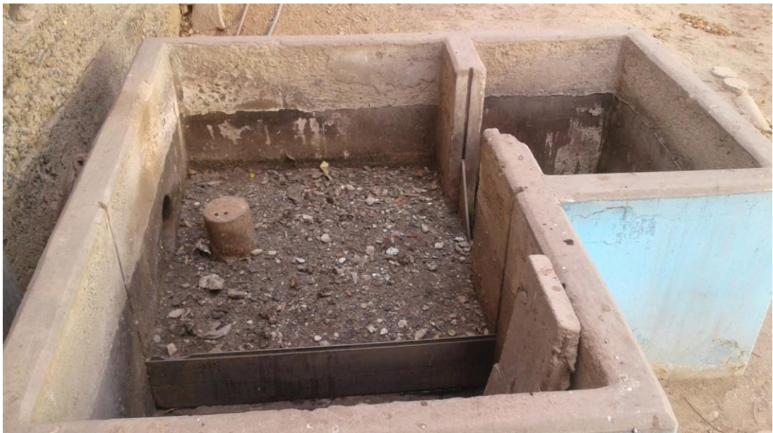
Fotografía 02: En la imagen se muestra la captación de agua residual cruda de la PTAR del CITRAR FIA – UNI, la imagen fue tomada durante la restricción de agua residual por SEDAPAL S.A. Estos cortes de agua influyeron en el arranque del reactor incrementando los días de obtención del post arranque.
