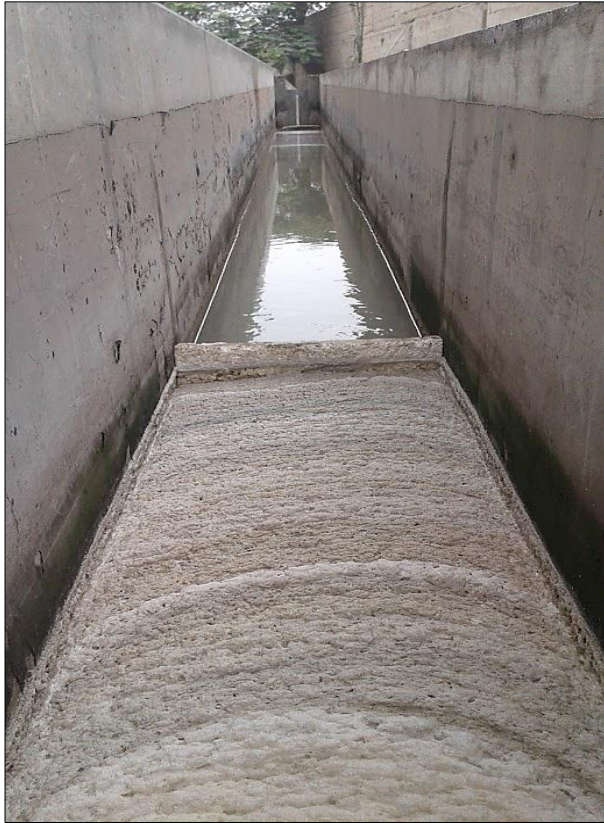
Fotografía 07: Retención de natas en el desarenador por la colocación del material de technopor . Esto evitaría que llegue una excesiva cantidad de natas al reactor UASB modificado.
