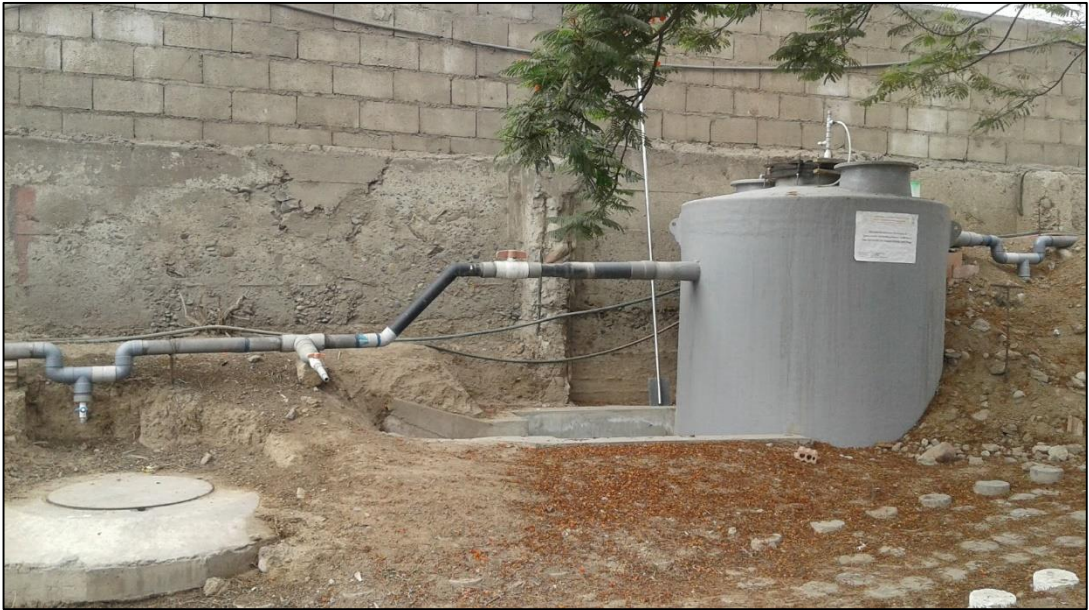
Fotografía 01: Reactor UASB modificado a escala real, se muestran los sellos hidráulicos y las válvulas de mantenimiento para la limpieza de la tubería de salida, las mismas que deben realizarse de forma diaria para asegurar obtener un efluente representativo para su análisis en el laboratorio.
