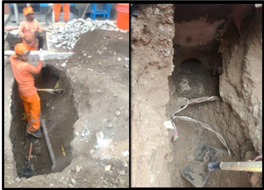
Figura N°10 Interferencias con redes de energía eléctrica (Fuente propia)
