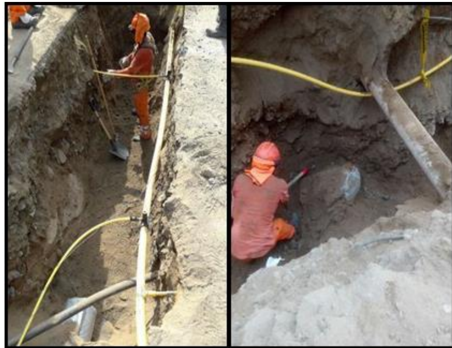
Figura N°11 Interferencias con redes de gas natural (Fuente propia)
