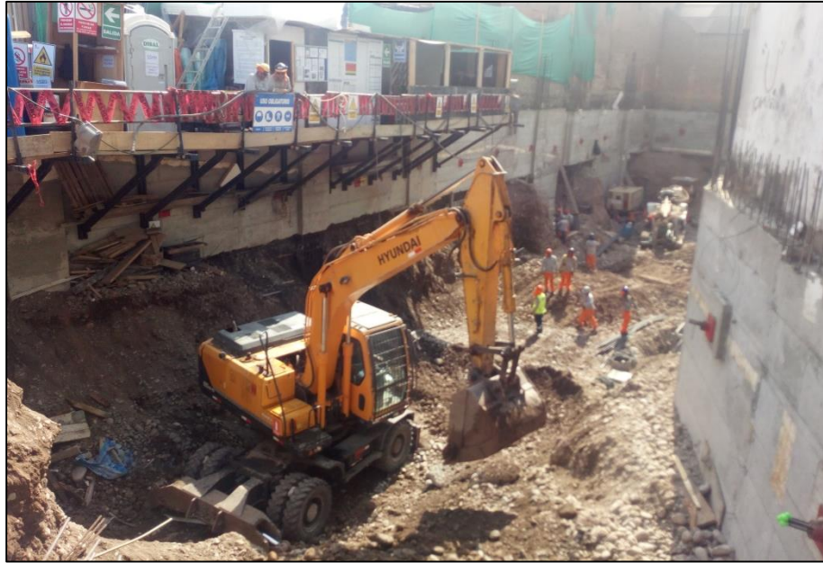
Gráfico N°4.10: 2da Etapa – Excavación masiva con dos excavadoras. Fuente: Fotografía obra Edificio Tai Loy, Surquillo-Lima, 2017.
