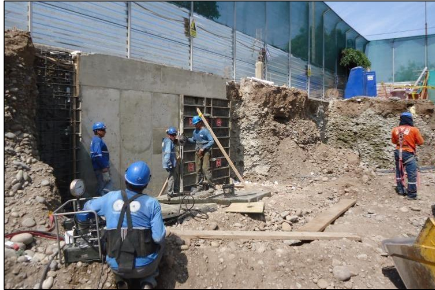
Gráfico N°4.26: Colocación de molde y gato hidráulico. Fuente: Fotografía obra Tottus San Luis-Lima, 2013.
