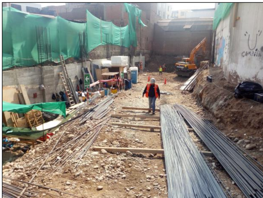
Gráfico N°1.2: Vista zona de trabajo en la segunda semana de trabajo. Fuente: Fotografía obra Edificio Tai Loy, Surquillo-Lima, 2017.
