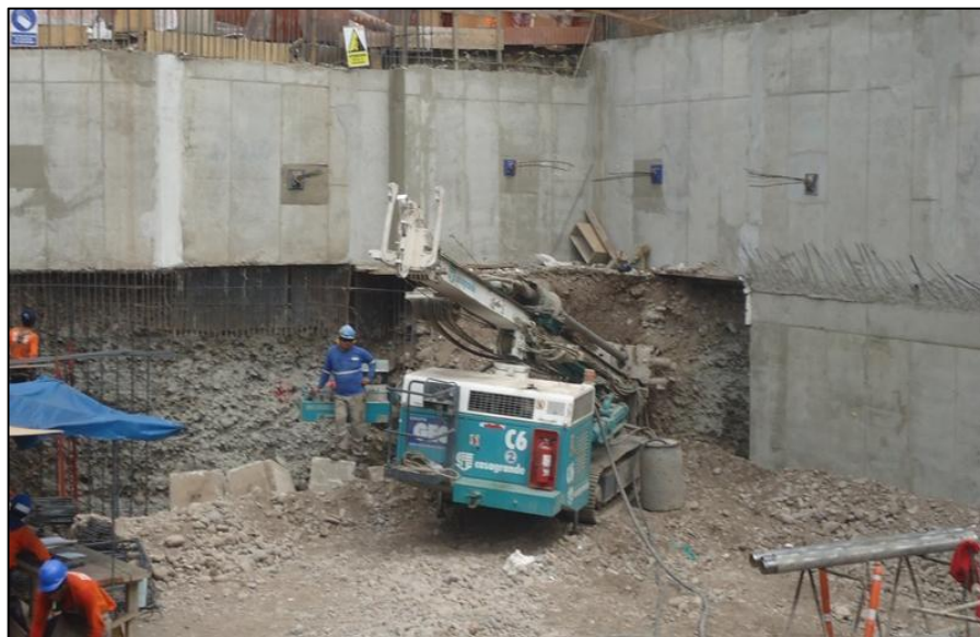
Gráfico N°4.25: Perforación y anclaje de cable tensor. Fuente: Fotografía obra Tottus San Luis-Lima, 2013.
