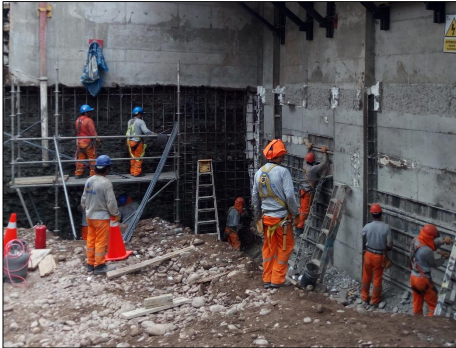
Gráfico N°4.17: colocación de acero de refuerzo. Fuente: Fotografía obra Edificio Tai Loy, Surquillo-Lima, 2017.
