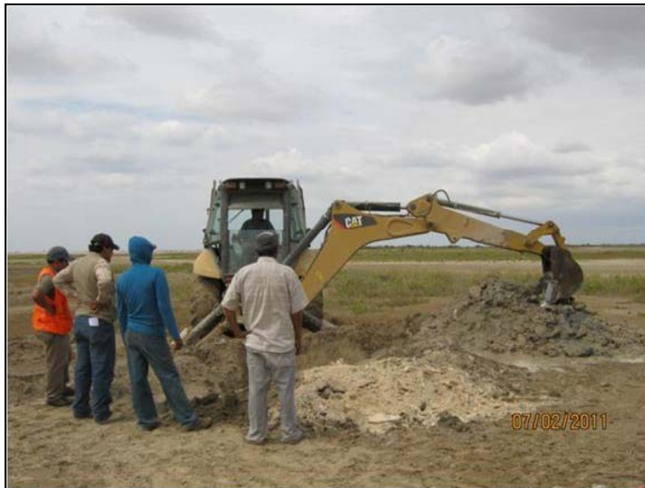
Foto N° 7 : Vista de la ubicación y ejecución de la calicata C-3. Se observa el material extraído durante la excavación.
