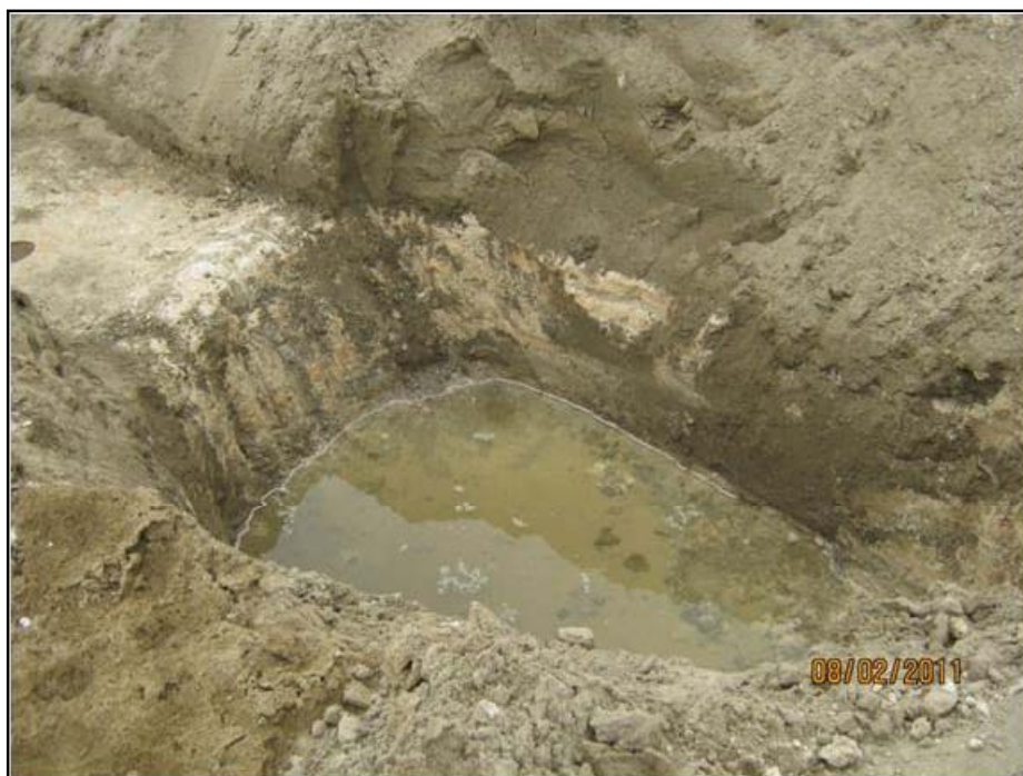
Foto N° 6 : Vista interior de la calicata C-2. Se observa el nivel freático que se encuentra a 1.40 m de profundidad.
