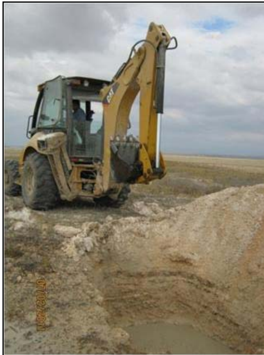
Foto N° 13 : Vista de la ubicación y ejecución de la calicata C-4. Se observa el material extraído durante la excavación, además de la presencia del nivel freático que se encontró a los 1.20 m de profundidad.
