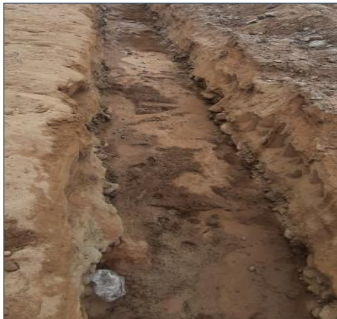
Figura N° 6.12 Vista de la zanja abierta y cama de arena colocada, previa al relleno con material de propio.
