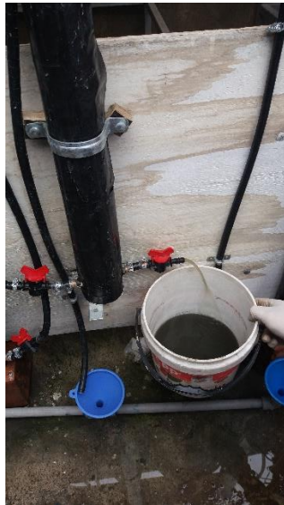
Figura 71: Purgado de agua de agua colmatada en los filtros
