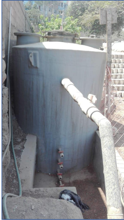
Figura 49: Reactor UASB-Tanque séptico de CITRAR
