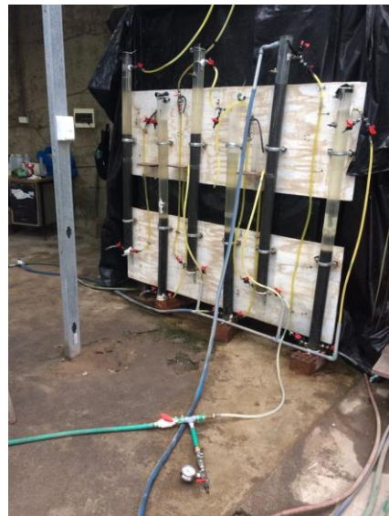
Figura 72: Operación de lavado de filtros de arena.
