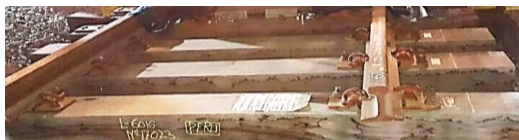
Fig. N° 2.6 Durmientes de madera akoga de cambiavías nuevos de la Línea 1 del Metro de Lima Fuente: Elaboración propia
