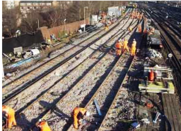
Fig. N° 3.16 Montaje de cambiavías en red de trenes orbitales de Londres mediante PEM-LEM Fuente: (The Rail Engineer, 2012)
