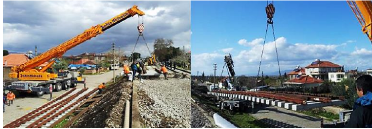
Fig. N° 3.9 Reemplazo de un cambiavía mediante grúas de carretera Fuente: (MAINLINE Consortium, 2014, p. 23)
