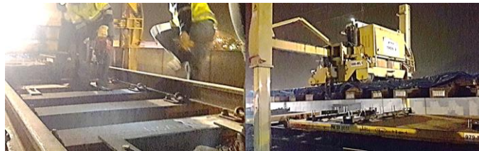
Fig. N° 2.53 Prueba dinámica tipo 3A en vía principal
