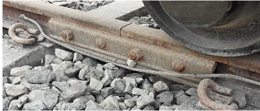
Fig. N° 2.11 Vía con junta embridada en Patio VES de la Línea 1 del Metro de Lima Fuente: Elaboración propia
