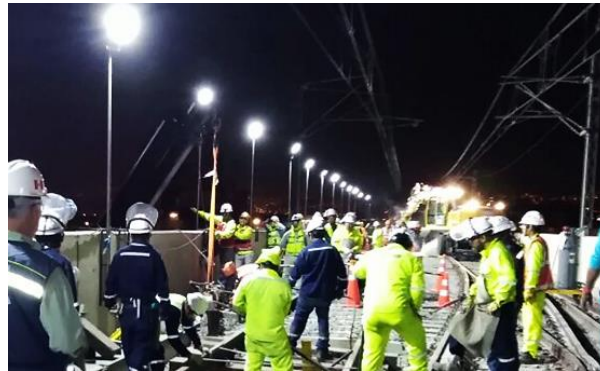
Fig. N° 4.8 Sistema de iluminación durante el alto impacto
