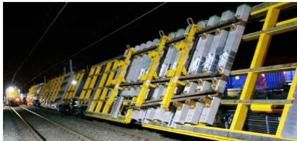
Fig. N° 3.14 Transporte de paneles de cambiavía por vagón basculante Fuente: (MAINLINE Consortium, 2014, p. 37)
