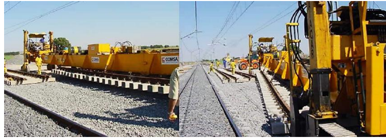
Fig. N° 3.4 Instalación de un cambiavía con sistema de viga-grúa VAIACAR Fuente: (MAINLINE Consortium, 2014, p. 18)
