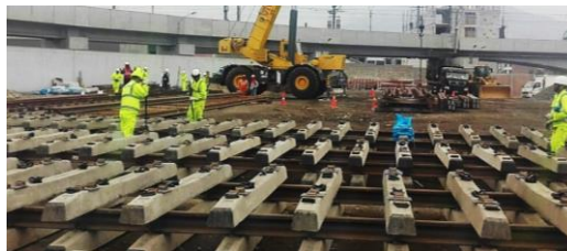
Fig. N° 2.7 Durmientes de concreto de vías nuevas de la Línea 1 del Metro de Lima Fuente: Elaboración propia
