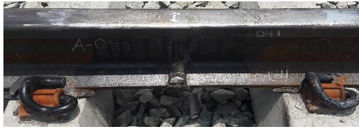
Fig. N° 2.12 LRS en vía principal de la Línea 1 del Metro de Lima
