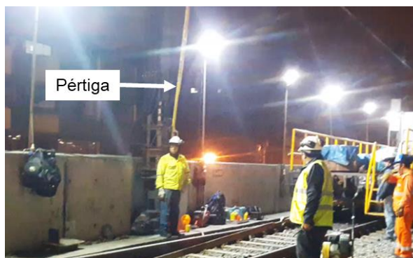
Fig. N° 4.7 Pértiga colocada en vía durante el alto impacto
