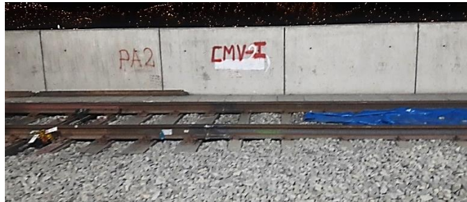
Fig. N° 2.46 Marcaje de inicio de cambiavía
