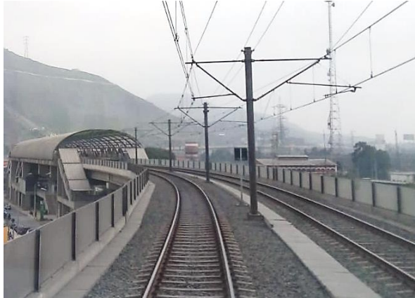
Fig. N° 4.4 Postes de catenaria cerca de la Estación Presbítero Maestro
