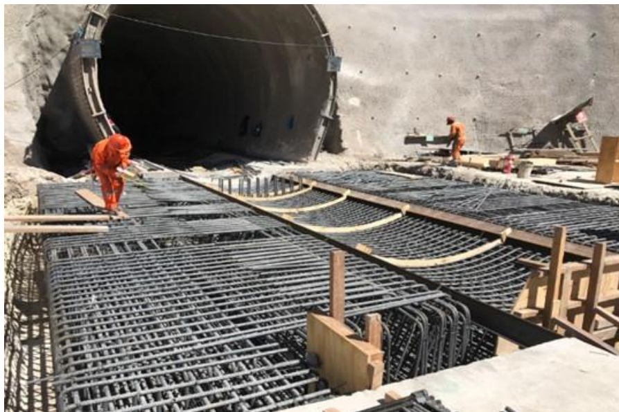
Figura 4.26: Acero de refuerzo habilitado y colocado de cuna de apoyo para TBM
