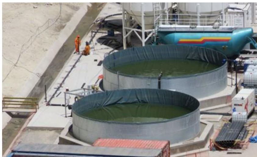
Figura 4.6: Tanques de almacenamiento de agua (Fuente: Registro fotográfico de obra)
