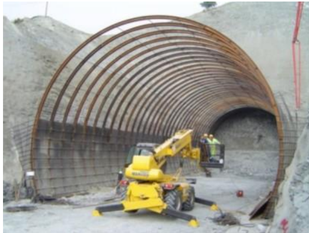
Figura 2.11: Cerchas formadas por perfiles de acero (Fuente: Ministerio de Transportes y Comunicaciones, 2016)
