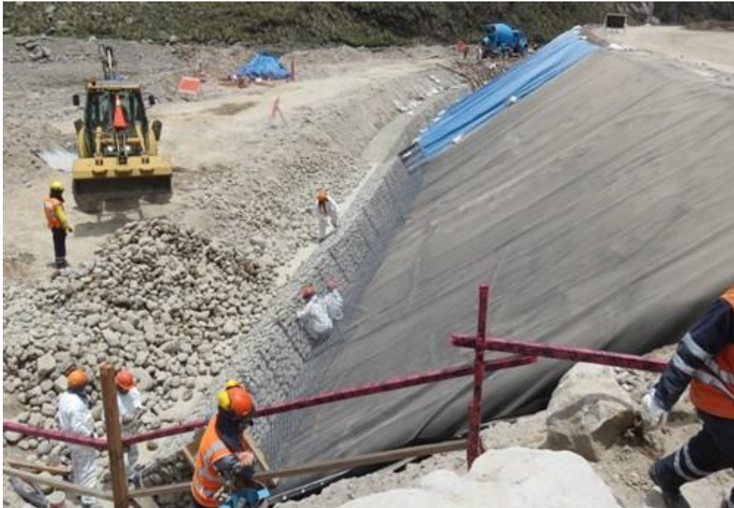
Figura 4.2: Colocación de bolonería de gaviones de mota (Fuente: Registro fotográfico de obra)
