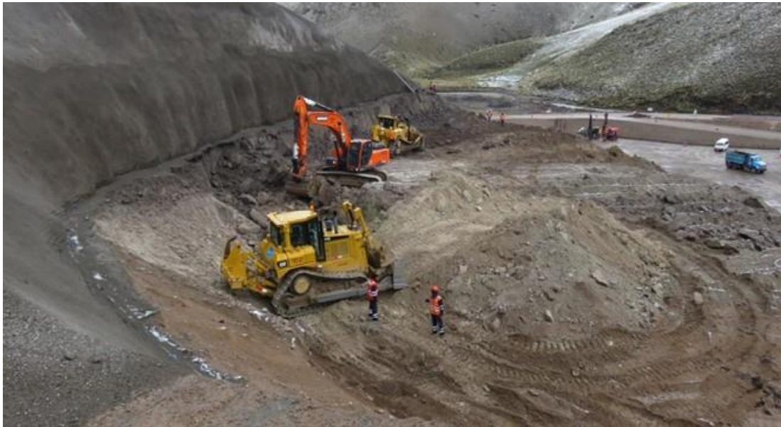
Figura 4.8: Eliminación de material de voladura de afrontamiento con equipos mecánicos (Fuente: Registro fotográfico de obra)
