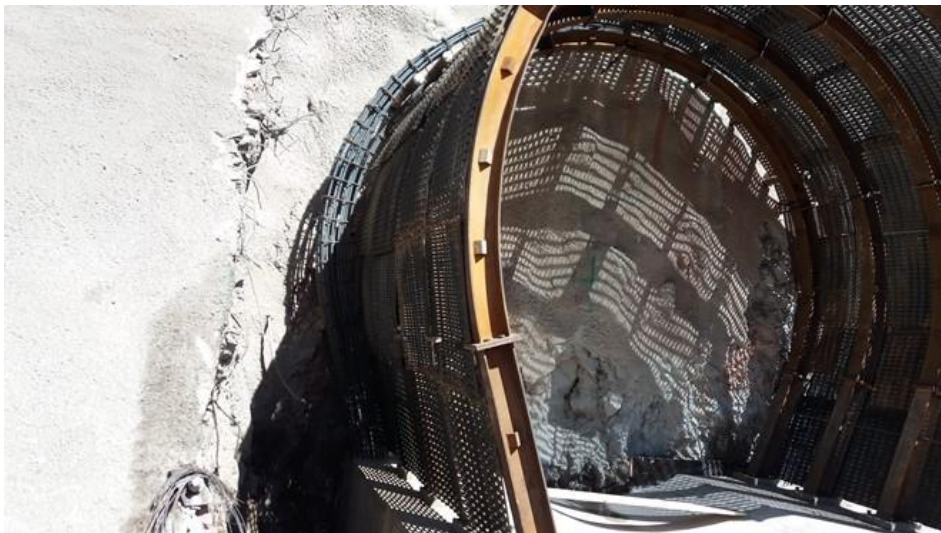
Figura 4.10: Estructura habilitada de visera y viga de atado (Fuente: Registro fotográfico de obra)
