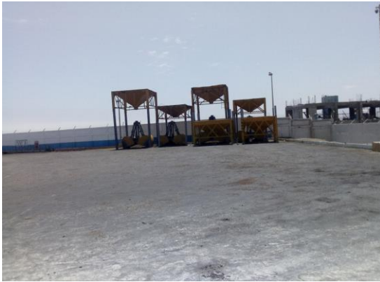
Estacionamiento de tolvas de terceros en la zona N°1
