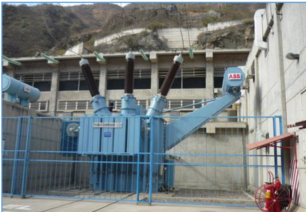
Fig. 2.4. Vista de un transformador de la C. H. Carhuaquero.
