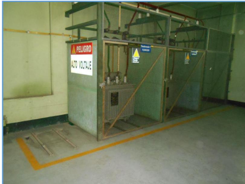
Figura: Transformadores de SSAA - C. H. Huampaní.
