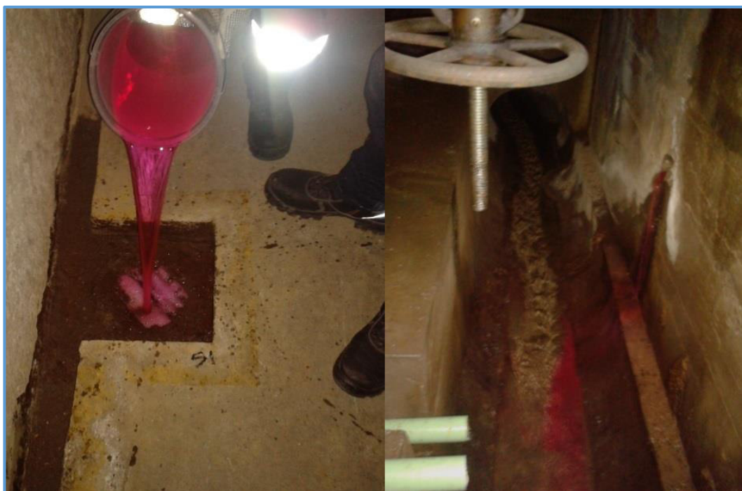
Fig. 3.2. Identificación de tuberías en la C.H. Huinco.
